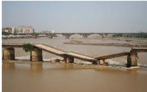
Εικόνα 17: Φθορά μεσόβαθρων γέφυρας λόγω σεισμού
