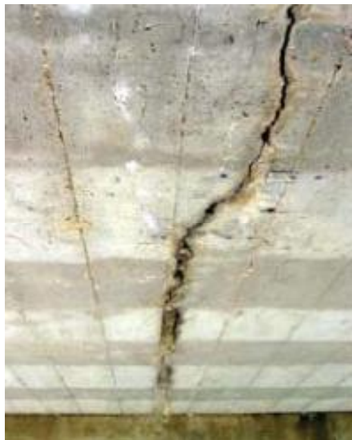
Εικόνα 40: Διαμηκης ρωγμή στην κάτω επιφάνεια του καταστρώματος της γέφυρας Martin Springs
