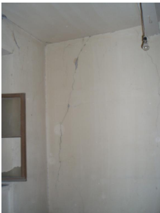
Εικόνα 152:Ρηγματώσεις στο χώρο Ι3 του ισογείου
