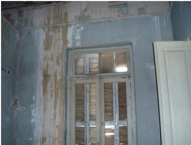
Εικόνα 84:Κηλίδες στον εσωτερικό τοίχο του α' ορόφου λόγω συνεχόμενης εισροής υδάτων από τη στέγη
