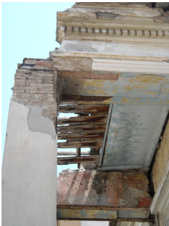
Εικόνα 110: Κατεστραμμένη στέγη και τραβηχτά κονιάματα στο πρόπυλο της πρόσοψης του κτιρίου
