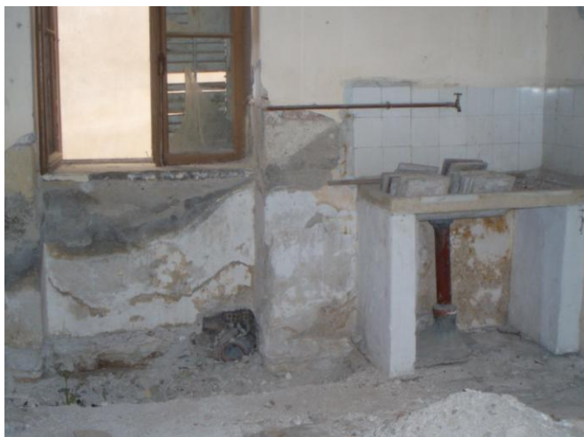
Εικόνα 78: Υδραυλικές εγκαταστάσεις του ισογείου
