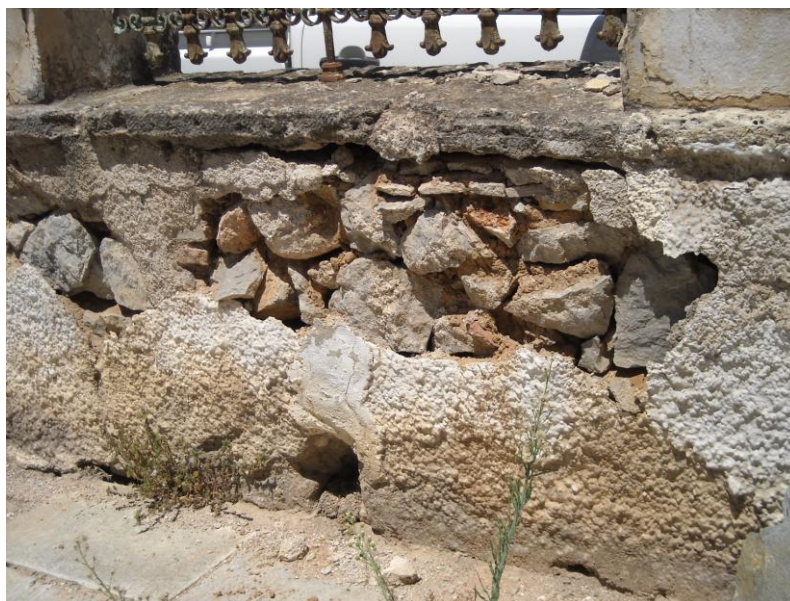
Εικόνα 106:Αποκολλημένο επίχρισμα στον περιμετρικό τοίχο του περιβάλλοντος χώρου
