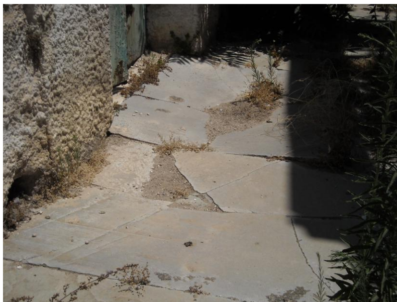
Εικόνα 107:Καθίζηση των πλακών επίστρωσης στον περιβάλλοντα χώρο
