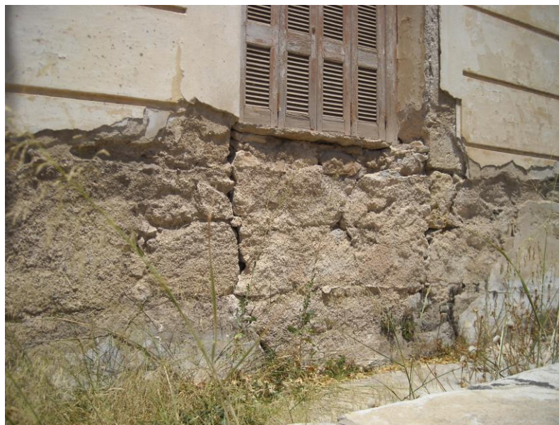
Εικόνα 117:Αποκλλημένο επίχρισμα στην νότια όψη του κτιρίου
