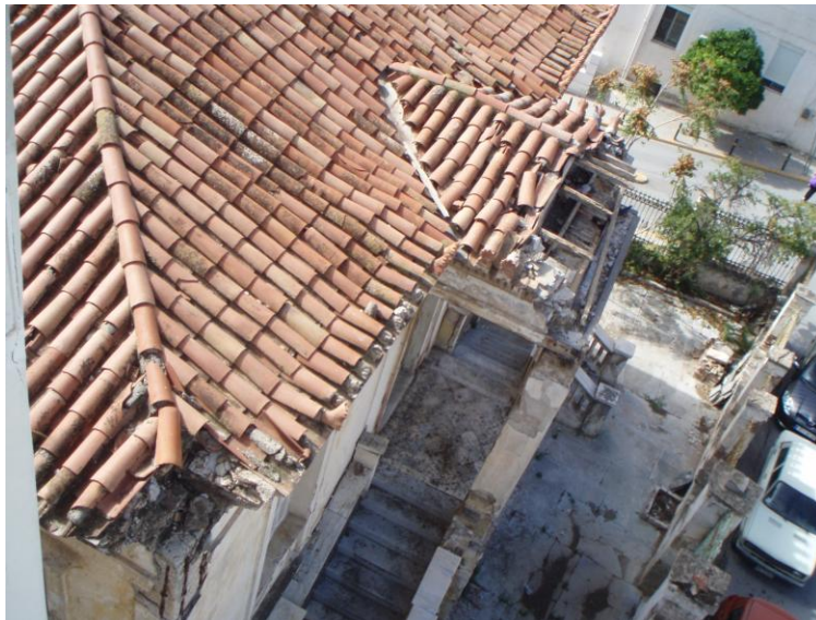
Εικόνα 83:Λεπτομέρεια στέγης, όπου φαίνεται το κατεστραμμένο πρόπυλο της πρόσοψης
