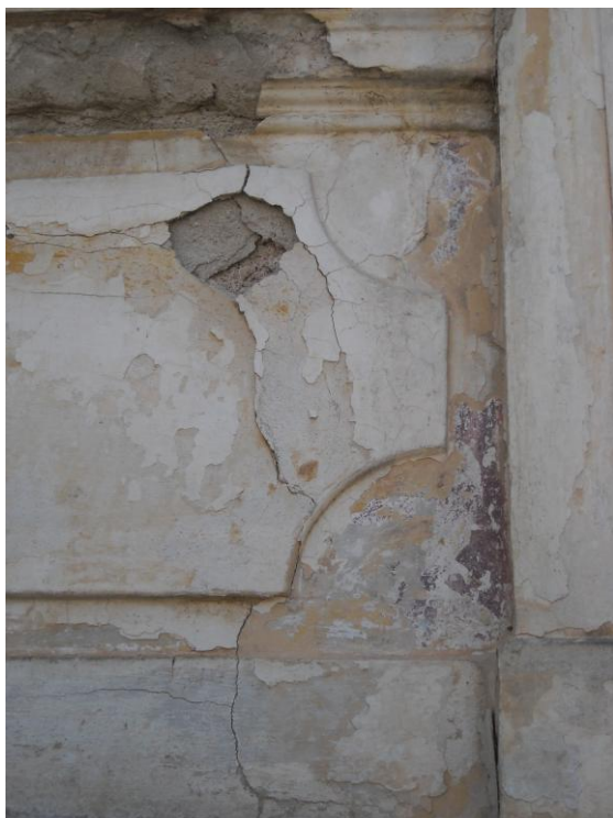
Εικόνα 116:Ρηγματώσεις και αποκολλημένο τραβηχτά κονιάματα στις όψεις του κτιρίου
