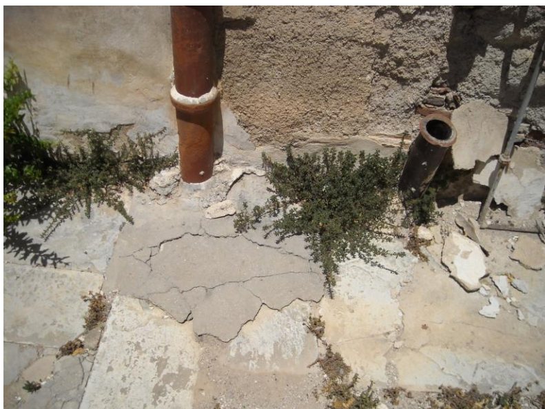
Εικόνα 165: Παραμορφώσεις και αλλοιώσεις στον εξωτερικό χώρο του κτιρίου
