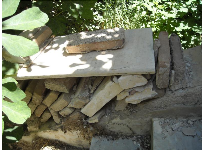
Εικόνα 100: Κατεστραμμένη κουπαστή του κεντρικού κλιμακοστασίου
