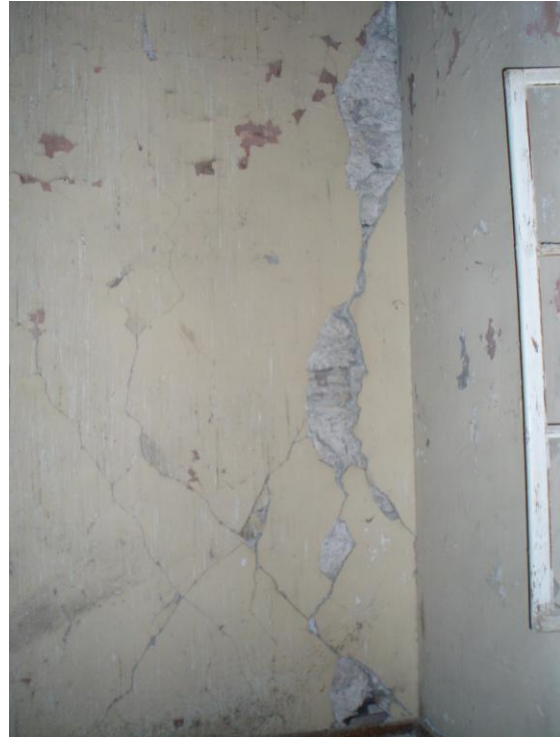
Εικόνα 83: Η ίδια διαμπερής ρωγμή στο χώρο Π4 του α' ορόφου
