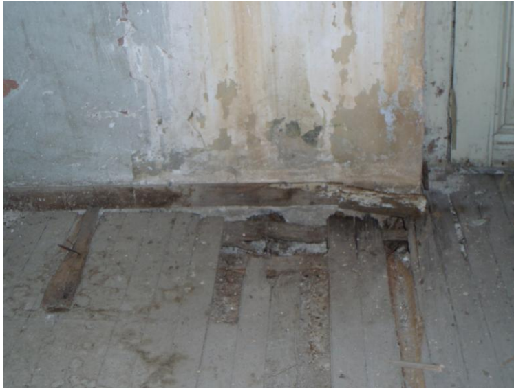
Εικόνα 86: Κατεστραμμένες ξύλινες σανίδες λόγω συνεχόμενης εισροής υδάτων από τη στέγη
