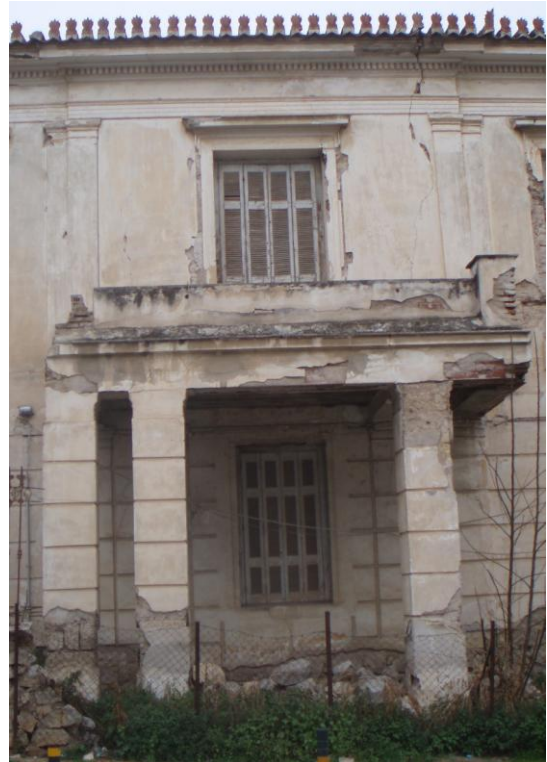
Εικόνα 105: Η ανατολική όψη του εξώστη, όπου φαίνεται ο κατεστραμμένος πεσσός στήριξης
