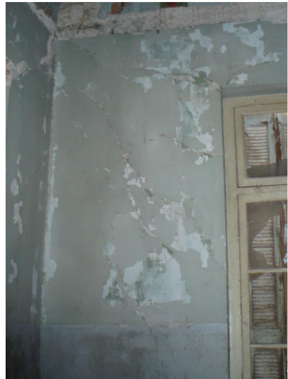
Εικόνα 157:Φθορές στα επιχρίσματα των τοίχων του α' ορόφου
