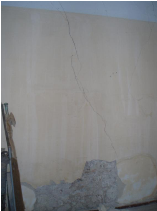
Εικόνα 93: Αποσαθρωμένο επίχρισμα και ρηγματώσεις στο χώρο Ι6 του ισογείου
