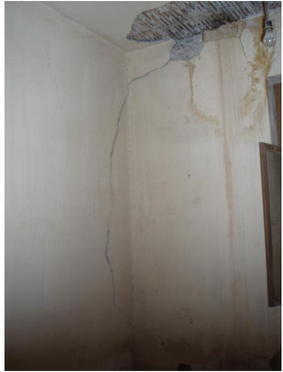
Εικόνα 148: Διαμπερή ρηγμάτωση, κηλίδες, και αποκόλληση επιχρίσματος στην οροφή στο χώρο Ι4 του ισογείου
