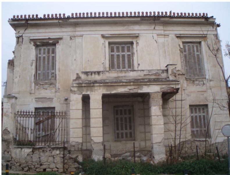
Εικόνα 109:Ανατολική όψη του κτιρίου, όπου διακρίνεται ο κατεστραμμένος περιμετρικός τοίχος και εναπομείναντα κιγκλιδώματα
