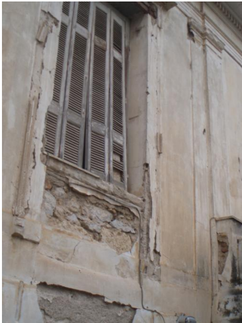
Εικόνα 87: Εξωτερικό κούφωμα το οποίο έχει αποκολληθεί από την τοιχοποιία
