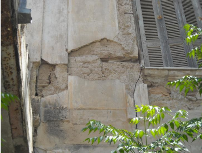
Εικόνα 89:Αποκολλημένο επίχρισμα στην ανατολική όψη
