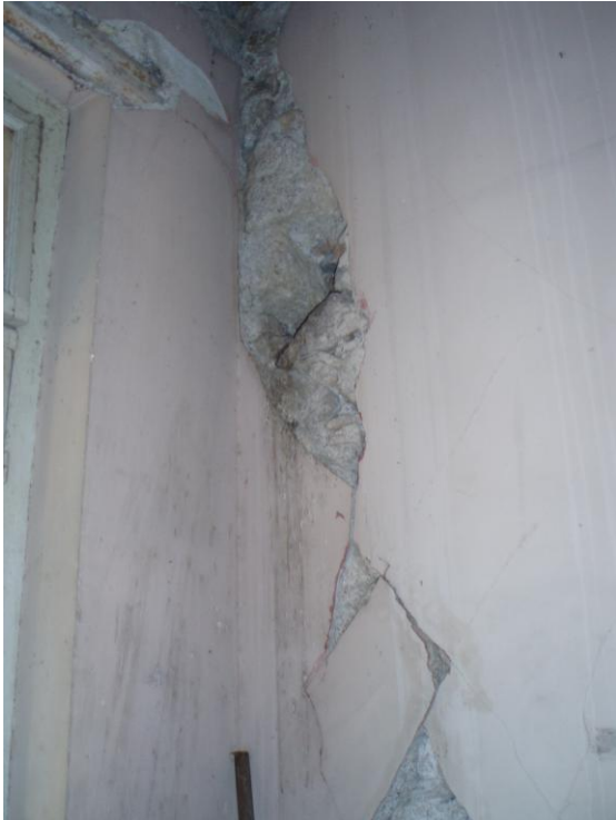
Εικόνα 82: Διαμπερής ρωγμή στο χώρο Π15 του α' ορόφου
