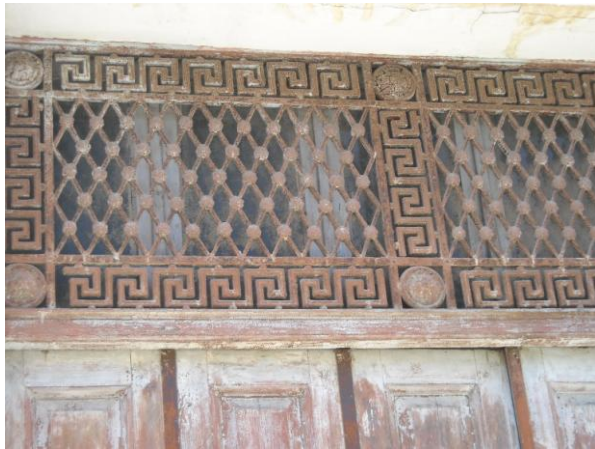
Εικόνα 88: Η σιδεριά της εξώθυρας στη νότια είσοδο, εμφανώς οξειδωμένη
