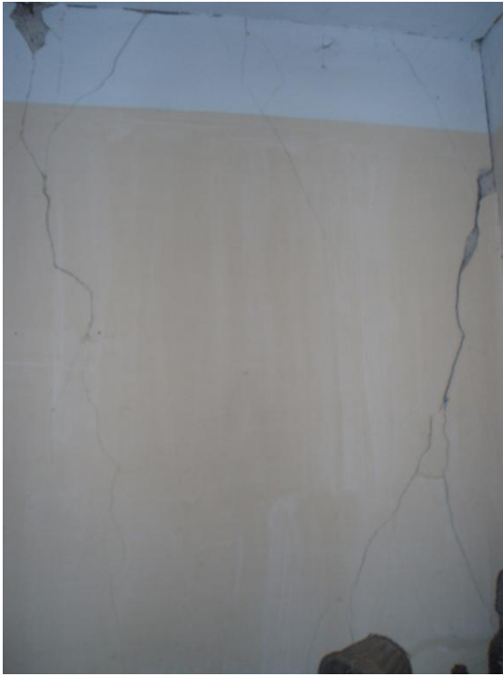
Εικόνα 147: Διαμπερείς ρηγματώσεις στο χώρο Ι6 του ισογείου
