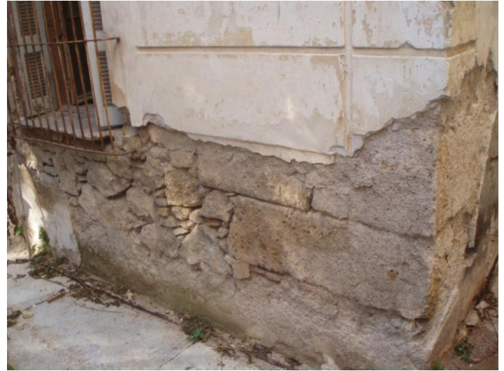
Εικόνα 90:Αποκολλημένο επίχρισμα στη νότια όψη
