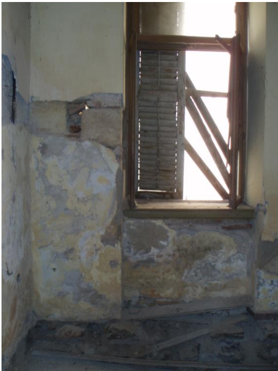
Εικόνα 80: Ανερχόμενη υγρασία στο χώρο ΙΙ8 του ισογείου
