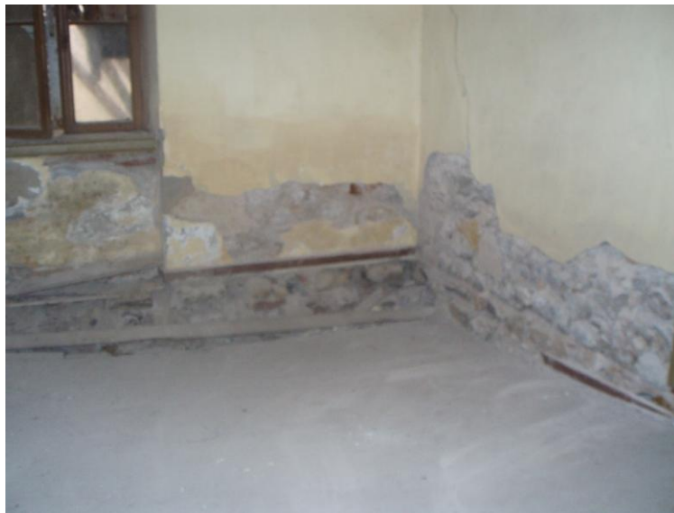
Εικόνα 85:Καθίζηση στο πάτωμα του χώρου 18 του ισόγειου
