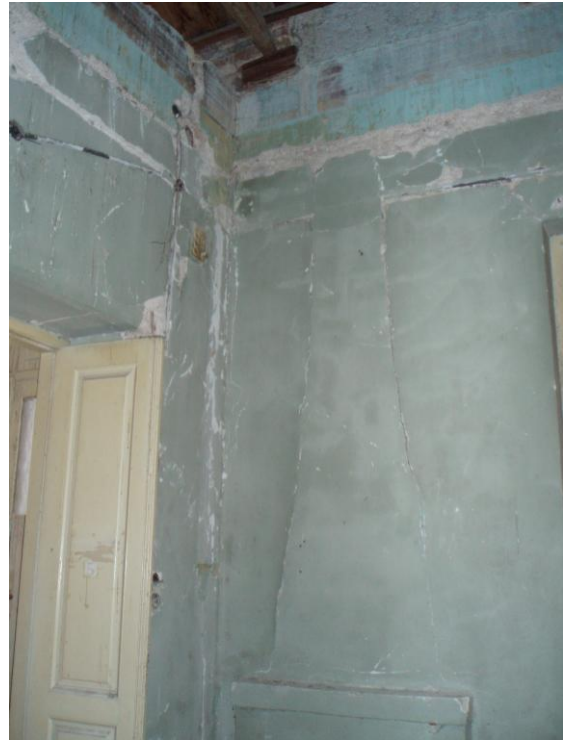
Εικόνα 94: Έντονες ρηγματώσεις στο χώρο ΙΙ8 του α' ορόφου
