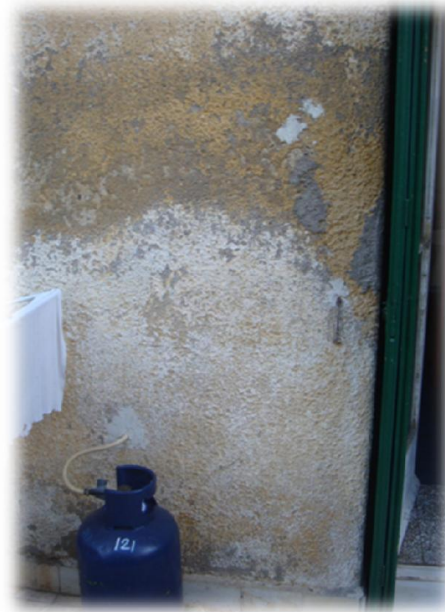
Εικόνα 196: Περιμετρική ζώνη υγρασίας του κτιρίου
