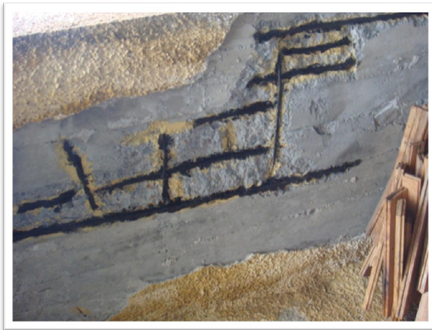
Εικόνα 194 : Αποκόλληση επιχρίσματος και αποκάλυψη οπλισμού
