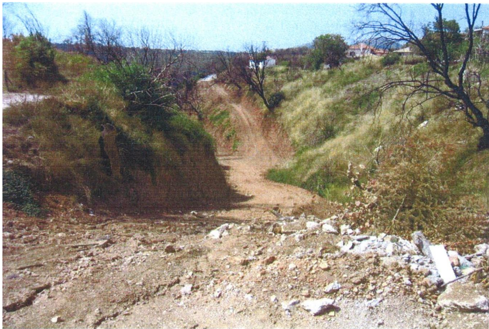
Φωτ. 10: Σε εξέλιξη κατασκευή έργου διάνοιξης περιφερειακού δρόμου Μηλιών. Παρατηρούνται φαινόμενα διάβρωσης λόγω της ανεξέλεγκτης ροής των επιφανειακών νερών.[13]
