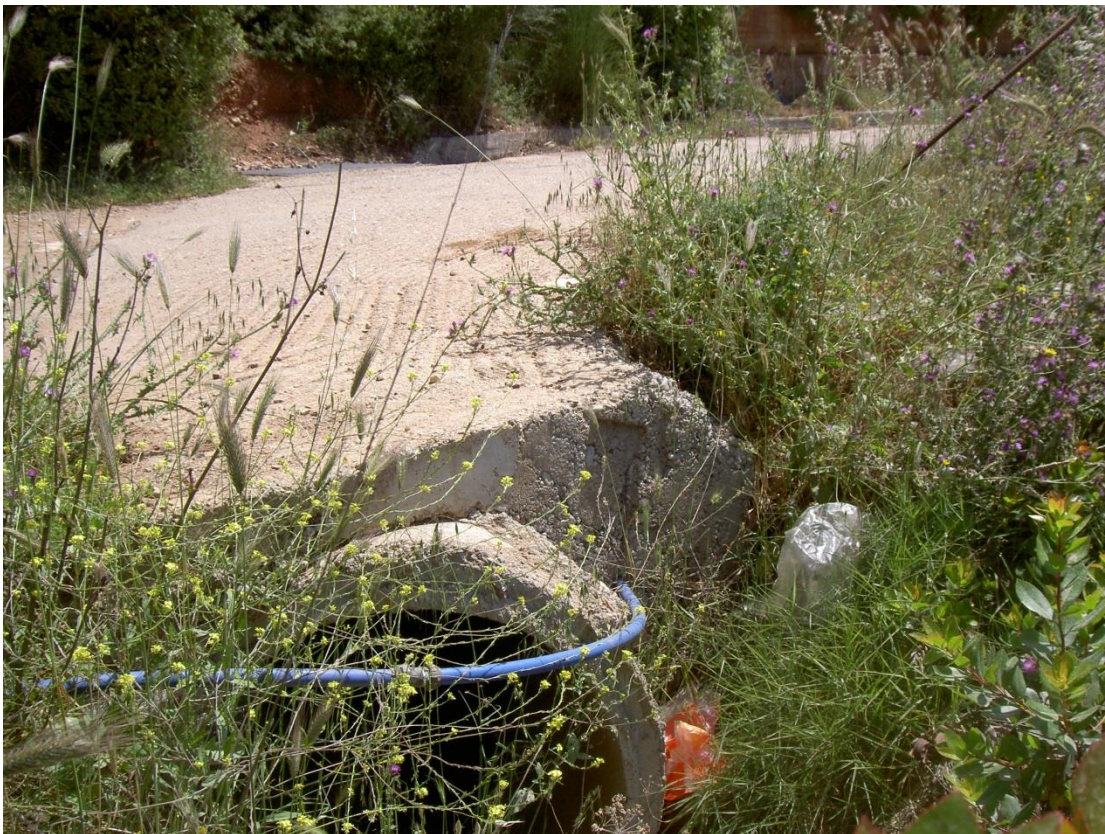
Εικόνα 12: Άποψη του σωληνωτού αγωγού κάτω από τον δρόμο ο οποίος απομακρύνει τα όμβρια ύδατα από το φρεάτιο συλλογής προς το υδρόρευμα.
