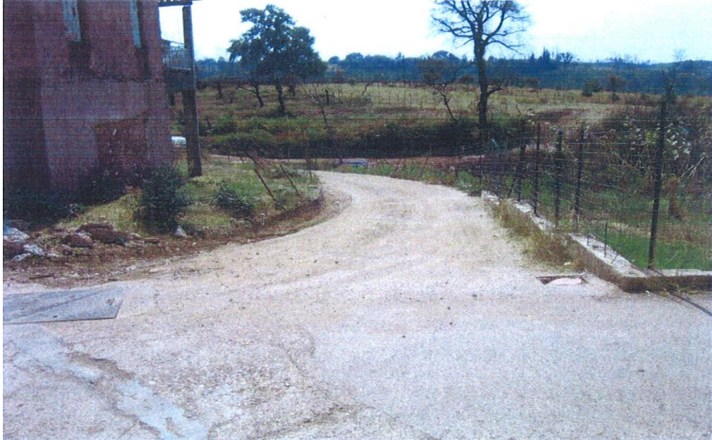
Φωτ. 11: Τσιμεντένιος δρόμος όπου συγκεντρώνονται όμβρια νερά και διοχετεύονται προς τον κατάντη υπό διάνοιξη δρόμο (ΘΕΣΗ Β).[13]
