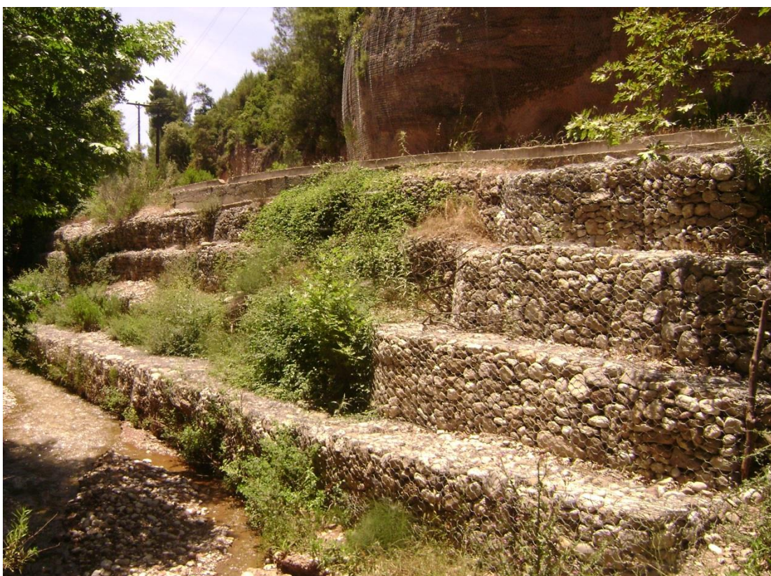
Εικόνα 2: Τοίχος από συρματοκιβώτια κάτω από την οδό για προστασία της απο την διάβρωση του ρέματος.
