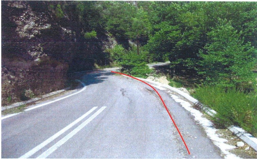
Φωτ. 15: Αστοχία στο οδόστρωμα.[13]
