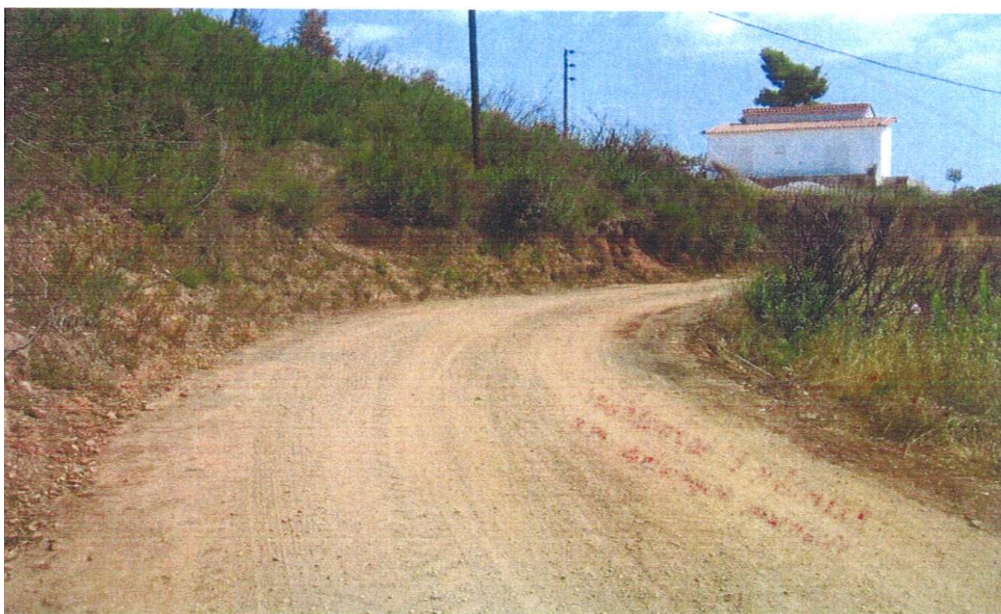
Φωτ. 25: Άποψη του χωματόδρομου που απαιτούνται μέτρα αποστράγγισης και παροχέτευσης των επιφανειακών νερών.[13]
