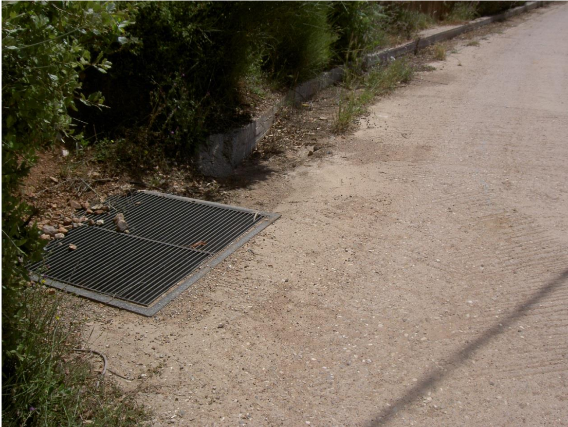
Εικόνα 11: Άποψη της τριγωνικής τάφρου η οποία καταλήγει σε φρεάτιο συλλογής ομβρίων με κάλυψη εσχάρας.
