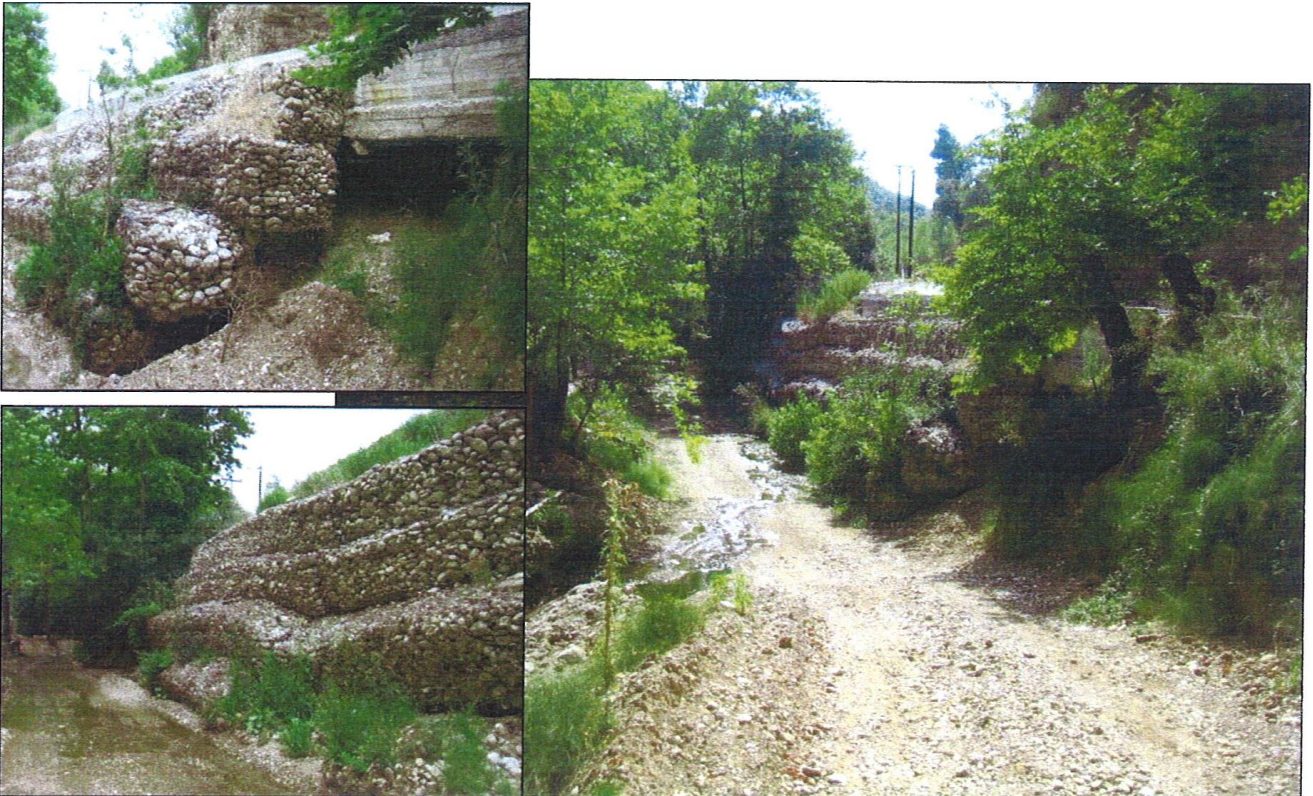
Φωτ. 16: Παραμόρφωση των συρματοκιβωτίων που έχουν τοποθετηθεί στο ρέμα για την κατασκευή της οδού.[13]
