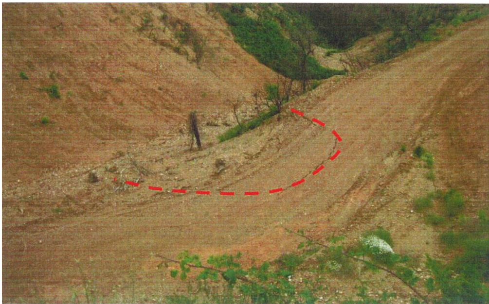
Φωτ. 7. Επίχωμα του περιμετρικού δρόμου που ήδη παρουσιάζει φαινόμενα αστοχίας[13]
