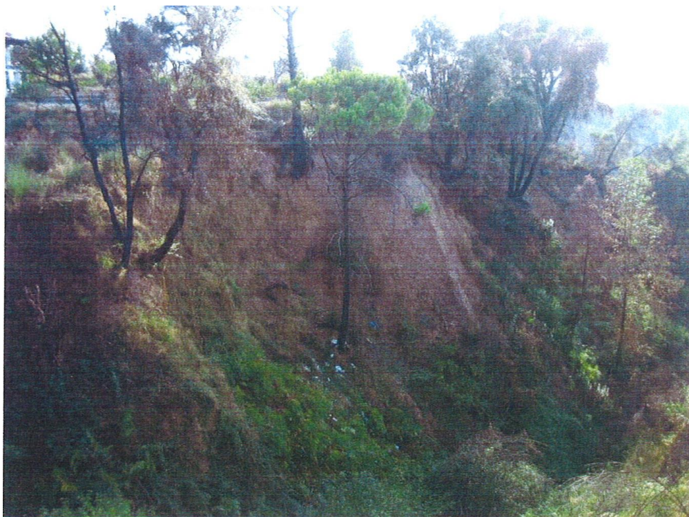
Φωτ. 1: Περιστροφική ολίσθηση στο νότιο πρηνές της μισγάγγειας, προκαλώντας απώλεια της στήριξης των υπερκείμενων εδαφών. Διακρίνεται η εντελώς αποσαθρωμένη δομή των κροκαλοπαγών. [13]
