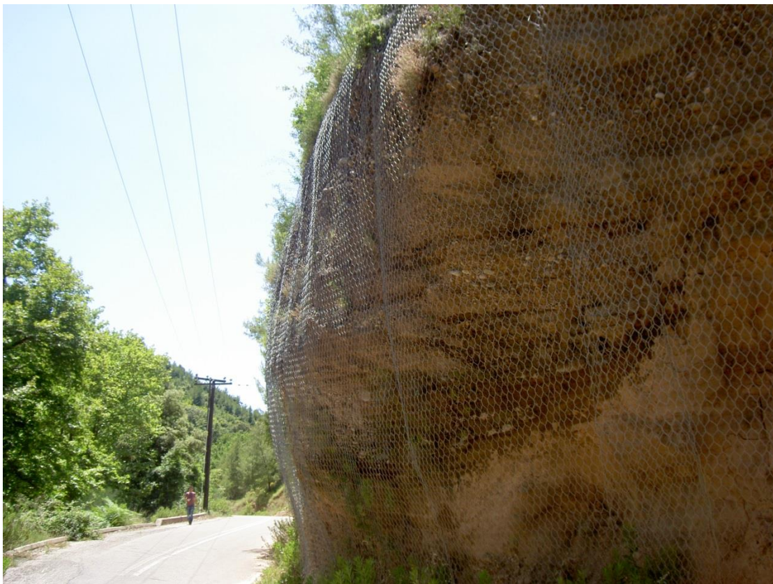
Εικόνα 4: Υψηλό και απότομο πρανές που το καθιστούσε επικίνδυνο χωρίς την τοποθέτηση γαλβανισμένου πλέγματος συγκράτησης καταπτώσεων στην οδό.
