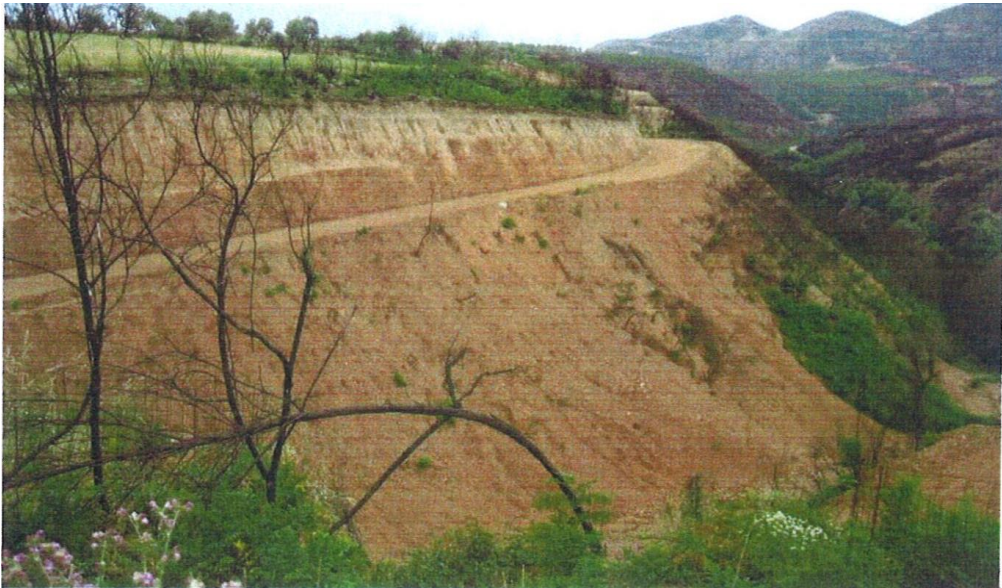
Φωτ. 6. Υπό κατασκευή περιμετρικός δρόμος που περιλαμβάνει υψηλά πρανή και «ανεξέλεγκτες» απορρίψεις υλικών εκσκαφής στα κατόντη.[13]
