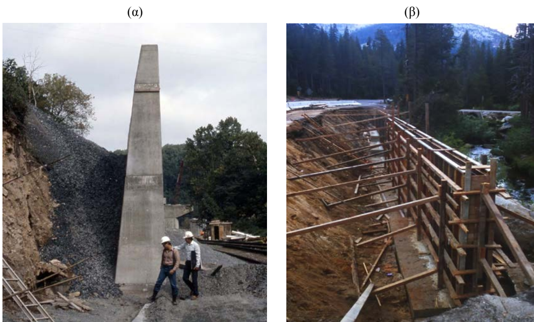
Εικόνα 3.5: (α) Τοίχος από οπλισμένο σκυρόδεμα (β) Διαδικασία κατασκευής τοίχου από οπλισμένο σκυρόδεμα.
