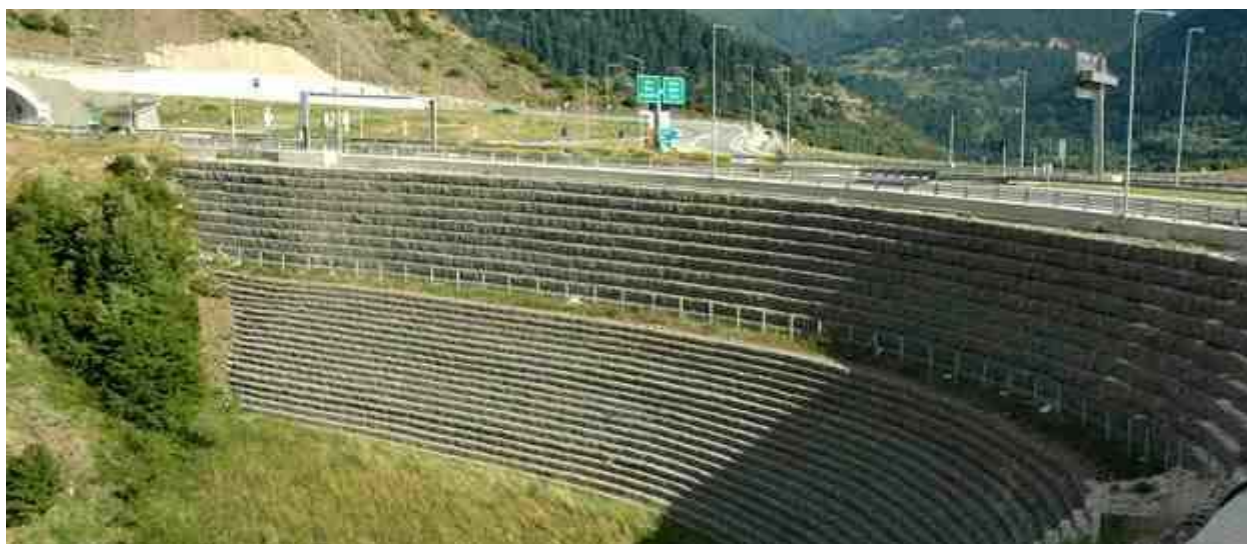
Εικόνα 3.19: Τοίχος αντιστήριξης από συρματοκιβώτια στην Εγνατία οδό
