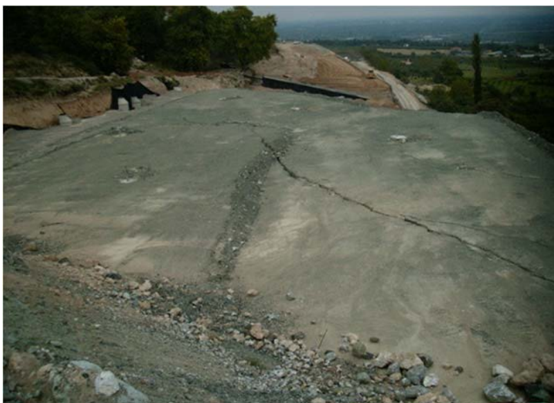
Εικόνα 6.19: Άποψη της αστοχίας του επιχώματος
