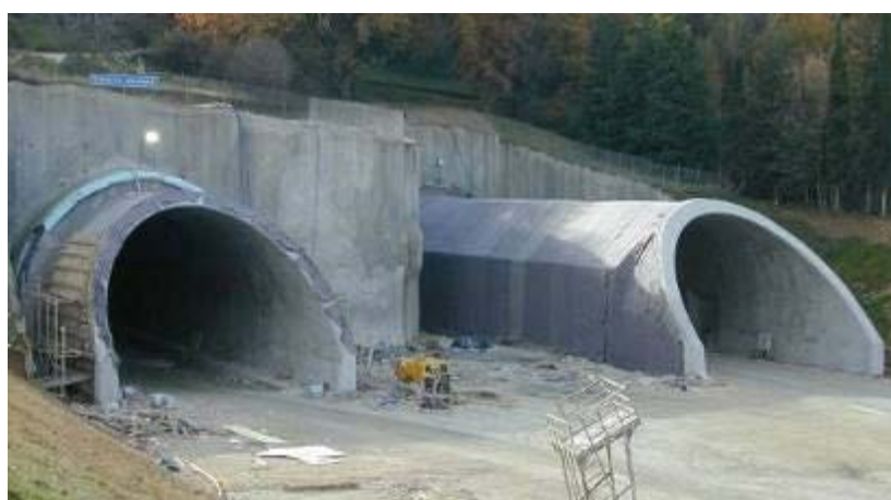
Εικόνα 5.20: Άποψη της τελικής επένδυσης στο τμήμα Cut & Cover. Εγνατία Οδός, Σήραγγα Δωδώνης.
