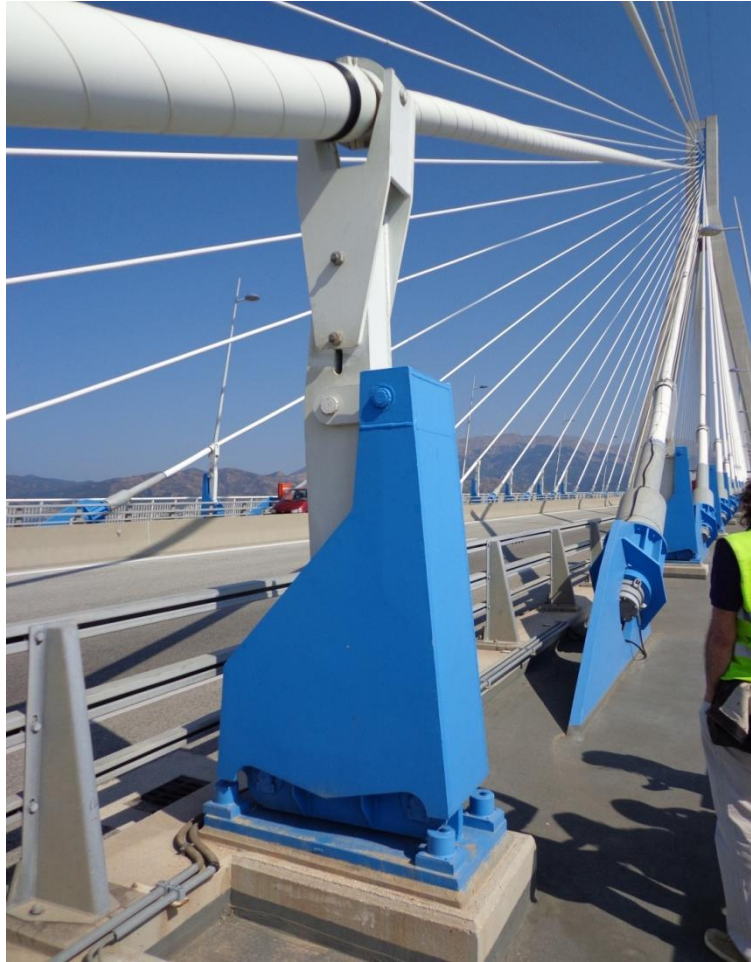
Εικόνα 4.10. Εξωτερική όψη αποσβεστήρα.
