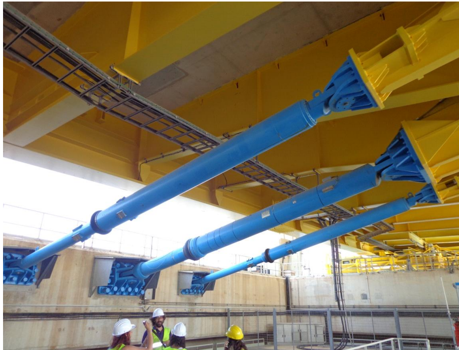
Εικόνα 3.4. Διάταξη των ασφαλειών και των αποσβεστήρων ιξώδους απόσβεσης στον πυλώνα M4 της Γέφυρας Ρίου – Αντιρρίου – διακρίνεται η σύνδεση με τον πυλώνα.
