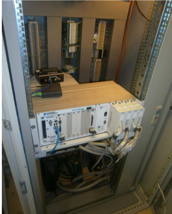
Εικόνα 3.10. Καταγραφικό σύστημα που επεξεργάζεται τα δεδομένα των αισθητήρων που βρίσκονται στην «περιοχή» του πυλώνα M4 της γέφυρας Ρίου – Αντιρρίου.
