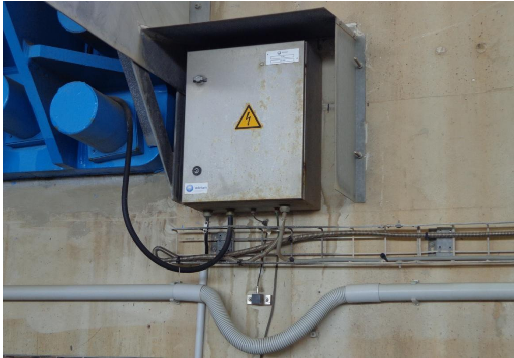
Εικόνα 3.2. Επιταχυνσιογράφος τοποθετημένος στο εσωτερικό τοίχωμα του πυλώνα M4 της Γέφυρας Ρίου – Αντιρρίου, κάτω από ηλεκτρολογικό κουτί διακλάδωσης.
