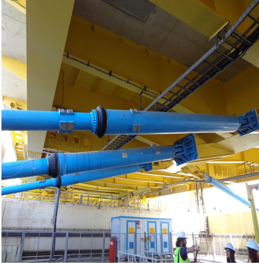
Εικόνα 3.3. Διάταξη των ασφαλειών και των αποσβεστήρων ιξώδους απόσβεσης στον πυλώνα M4 της Γέφυρας Ρίου – Αντιρρίου – διακρίνεται η σύνδεση με το κατάστρωμα.
