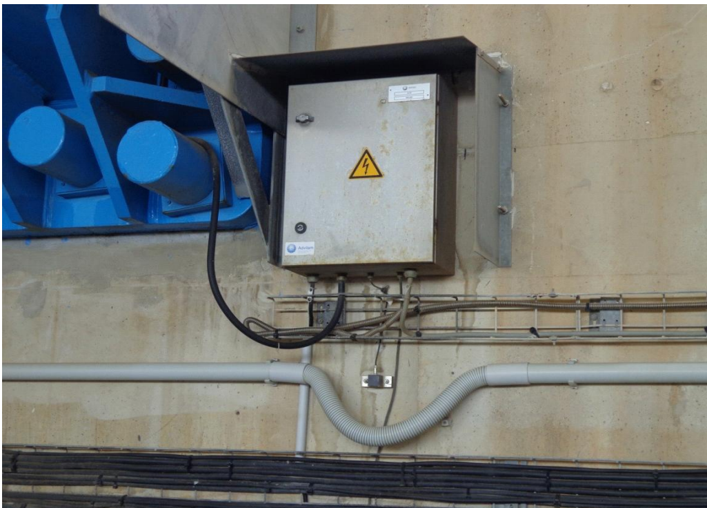
Εικόνα 3.9. Ηλεκτρολογικό κουτί διακλάδωσης, μέρος του συστήματος δομικής παρακολούθησης της Γέφυρας Ρίου – Αντιρρίου.
