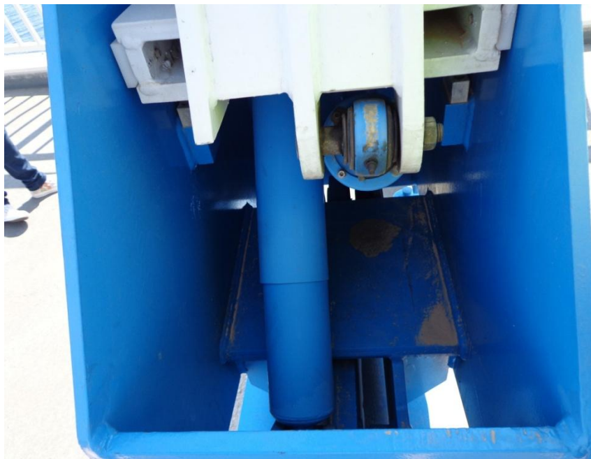
Εικόνα 4.11. Εσωτερική όψη αποσβεστήρα.
