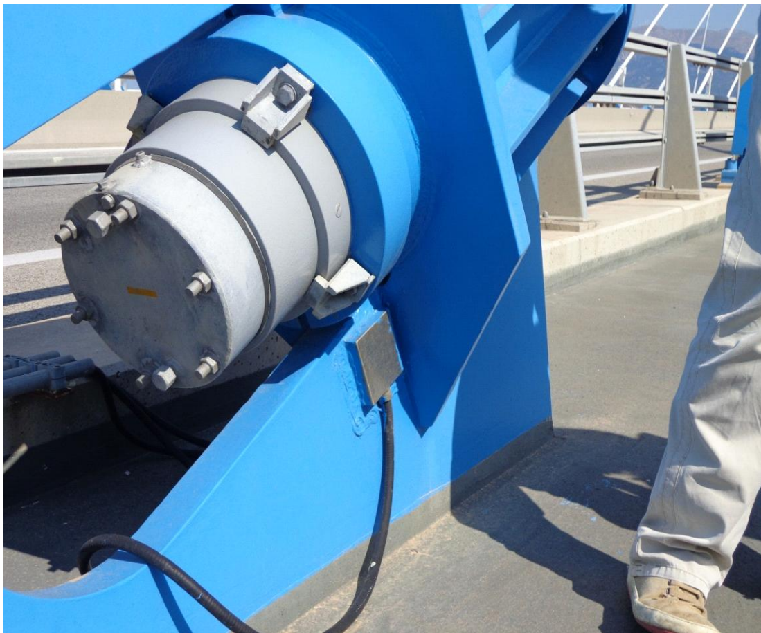
Εικόνα 3.8. Ροζέτα μηχανοσυστημάτων για τη μέτρηση των παραμορφώσεων στη θέση αγκύρωσης καλωδίου στη γέφυρα Ρίου – Αντιρρίου.
