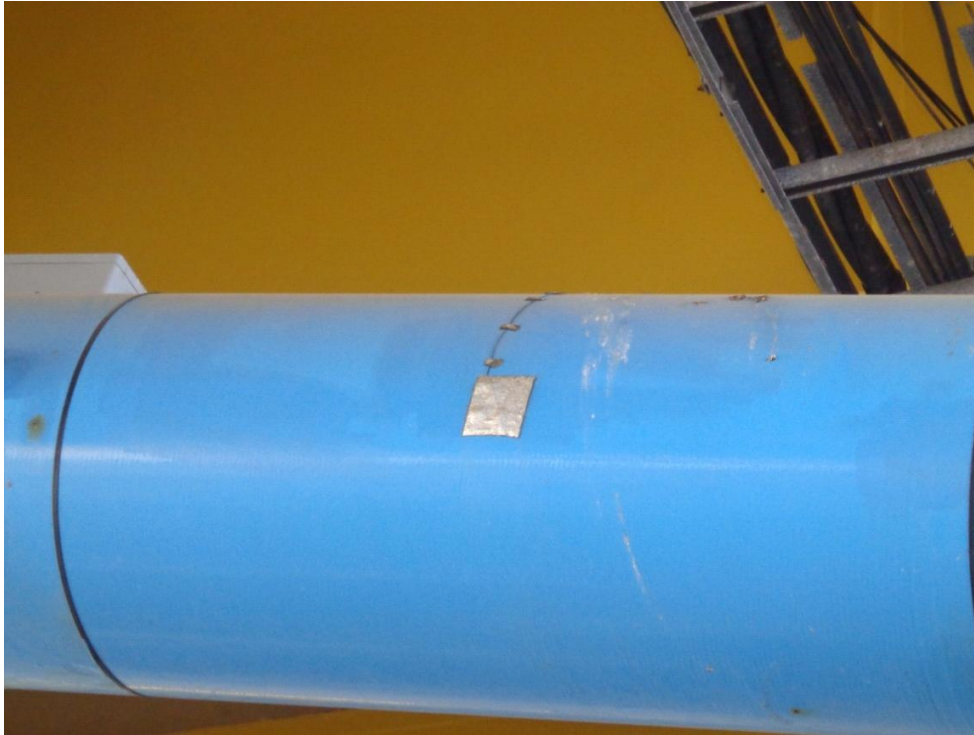
Εικόνα 3.5. Μηκυσιόμετρο (strain gage) τοποθετημένο σε ασφάλεια (fuse) του πυλώνα M4 της Γέφυρας Ρίου – Αντιρρίου με στόχο τη μέτρηση της ανεμοπίεσης.
