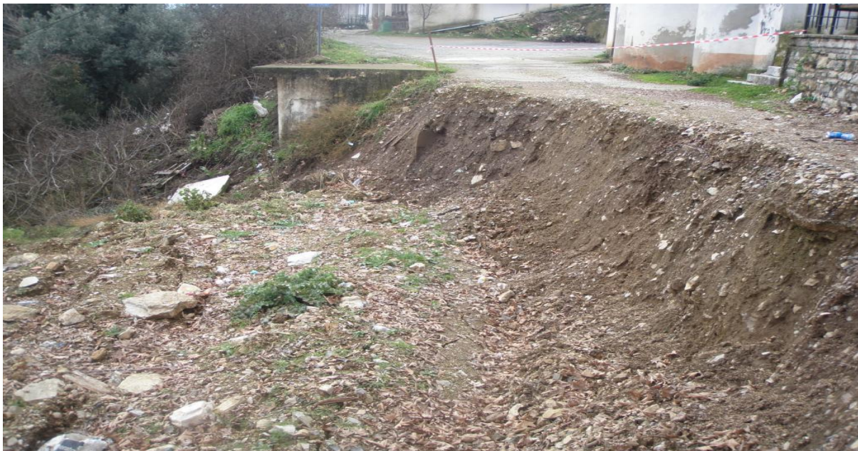
Εικόνα 5.8: Φωτογραφική απεικόνιση της κατολίσθησης
