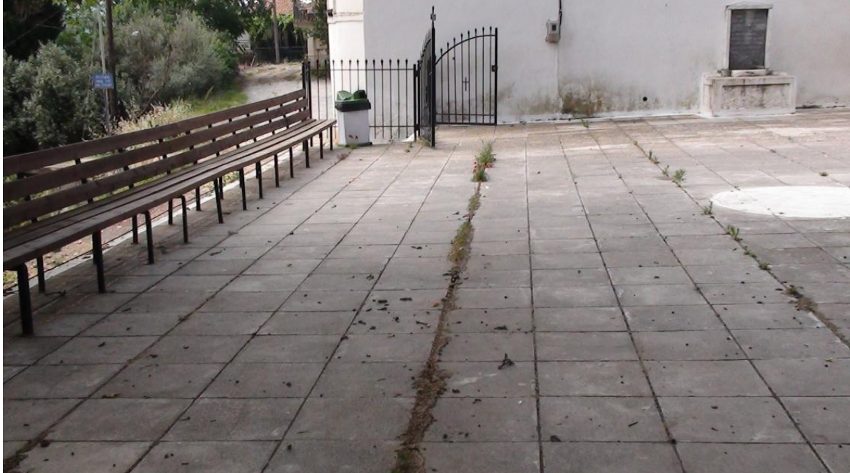
Εικόνα 5.9: Τα πλακάκια στον προαύλιο χώρο της εκκλησίας μόλις τέσσερα μέτρα από την κατολίσθηση έχουν ρωγματώδες.
