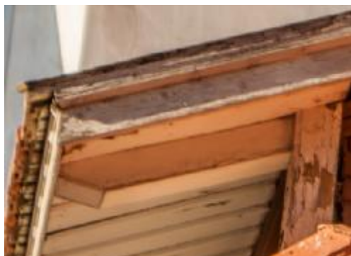
Εικόνα 76: Αποσάθρωση των ξύλινων δοκαριών
