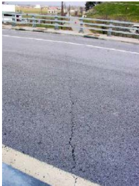
Εικόνα 1.13 Ρηγμάτωση στο κατάστρωμα (στην στρώση της ασφάλτου) λόγω καθίζησης ακροβάθρου [3].
