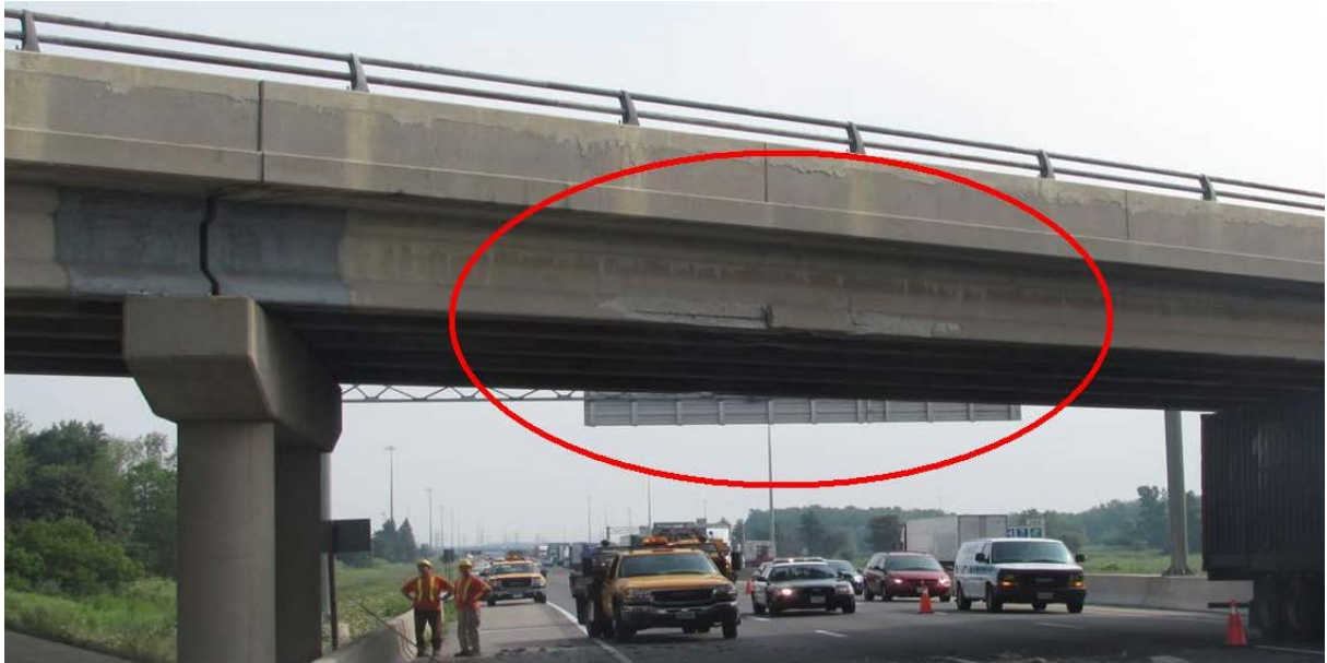
Εικόνα 1.17 Βλάβη σε δοκό του καταστρώματος της γέφυρας του αυτοκινητοδρόμου 115 στο Οντάριο του Καναδά [4].
