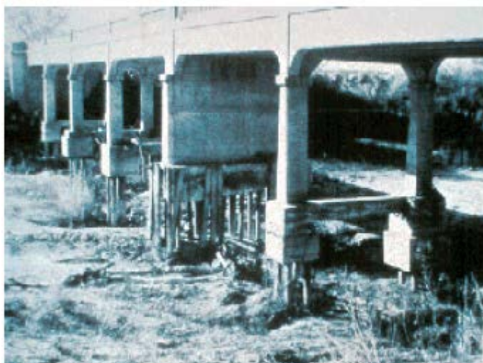
Εικόνα 1.10 Υποσκαφή στην περιοχή μεσοβάθρου που εκδηλώθηκε ως απομάκρυνση του περιβάλλοντος εδάφους θεμελίωσης [3].
