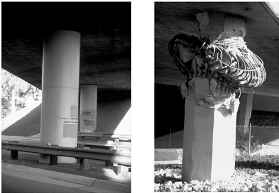
Εικόνα 1.18 Σύγκριση της σεισμικής συμπεριφοράς ενισχυμένου και μη ενισχυμένου βάθρου μετά το σεισμό του Northridge, California - άθικτο μεσόβαθρο ενισχυμένο με μεταλλικό κλωβό στη ράμπα της γέφυρας Cadillac Avenue, Santa Monica Freeway (αριστερά) και ολική μεσόβαθρου της γέφυρας Bull Creek στον αυτοκινητόδρομο 118 [5].
