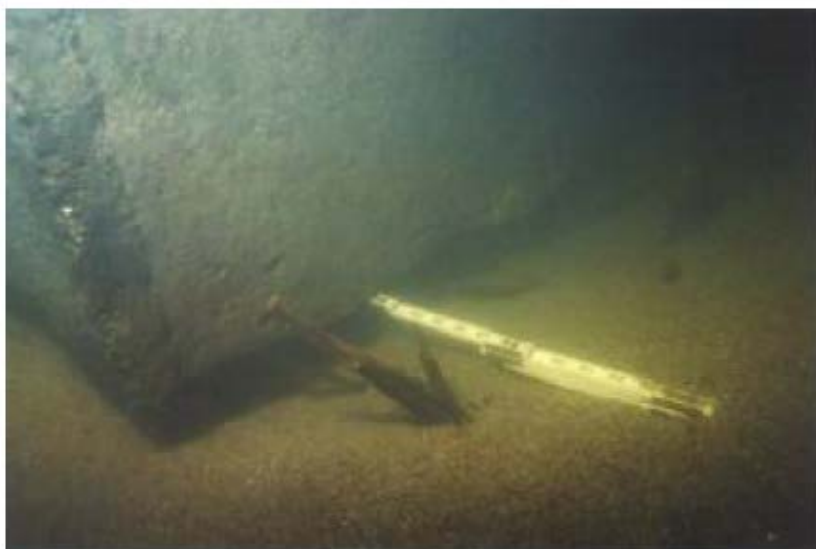
Εικόνα 1.5 Υποσκαφή σε ακρόβαθρο [3].
