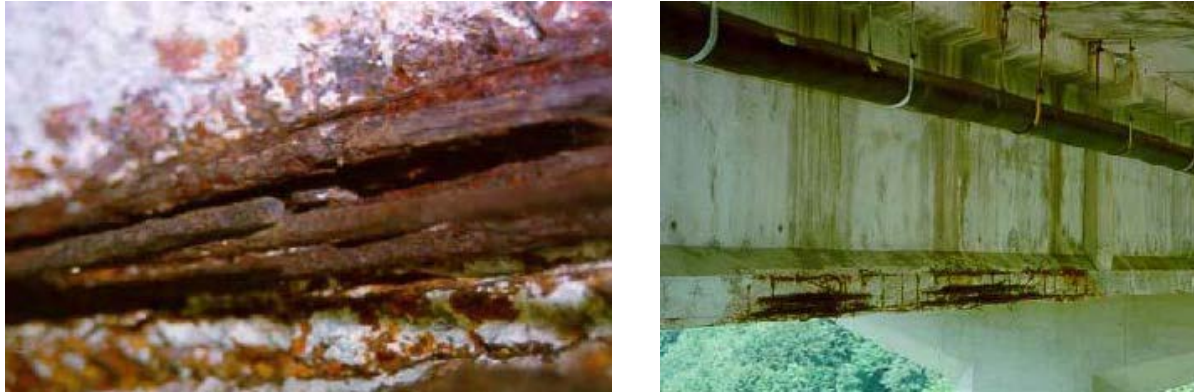
Εικόνα 1.14 Διαβρωμένοι τένοντες σε κατάστρωμα γέφυρας (αριστερά) και χαλαροί οπλισμοί σε δοκό του φορέα ανωδομής γέφυρας (δεξιά) [3].
