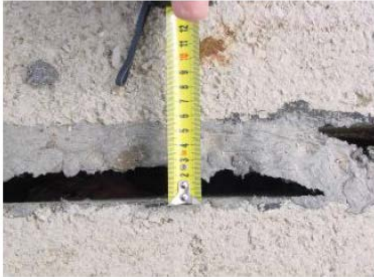
Εικόνα 1.4 Παρατηρούμενη διάνοιξη αρμού λόγω μετακίνησης του ακροβάθρου [3].
