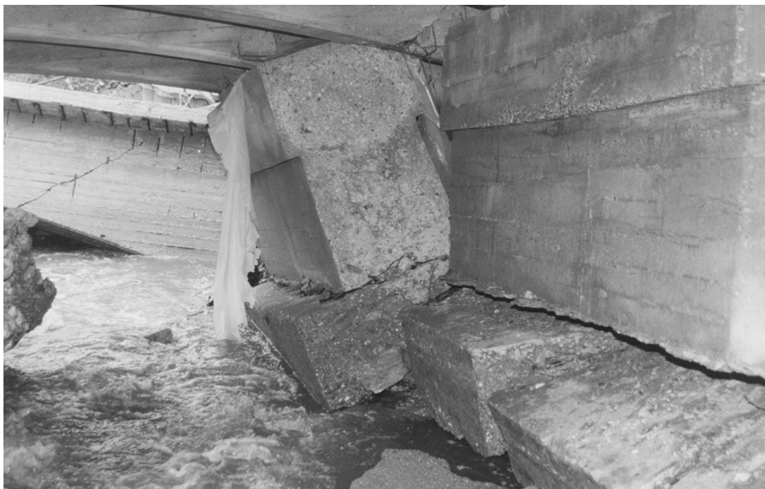
Εικόνα 1.20 Μετατόπιση και στροφή των βάρων της αμφιπροέχουσας γέφυρας Ζηλιάνια οφειλόμενη σε υποσκαφή [6].
