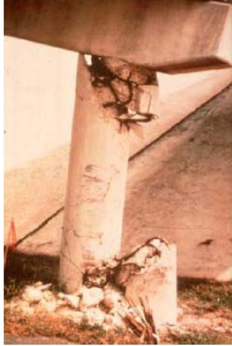
Εικόνα 1.12 Βλάβη μεσοβάθρου λόγω πρόσκρουσης οχήματος [3].
