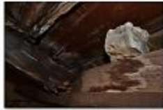
ΛΠ.868 ΚΑΤΑΣΤΡΟΦΗ ΣΤΕΦΗΣ
