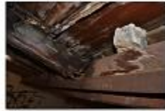
ΛΠ.869 ΚΑΤΑΣΤΡΟΦΗ ΣΤΕΦΗΣ
