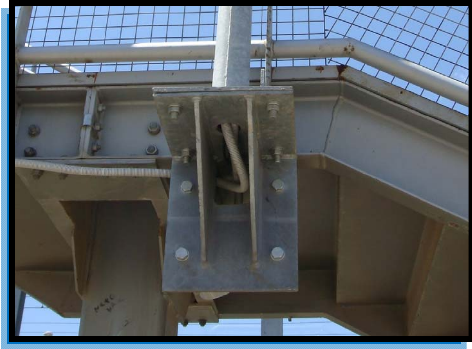
Φωτ. 4.12 Έδραση ιστού ηλεκτροφωτισμού.
