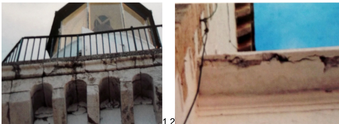
Εικόνα 93: 1, Διάβρωση λόγω επέμβασης με σκυρόδεμα, 2 Ρηγματώσεις στην πλάκα δώματος Πηγή : 'Πέτρινοι φάροι από το χθές στο σήμερα', Εργαστήριο Δομικών υλικών Τμήμα Πολιτικών Μηχανικών ΑΠΘ, Εκδόσεις: Κλειδάριθμος
