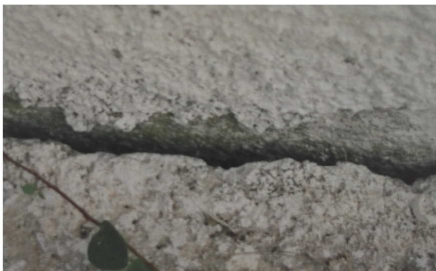
Εικόνα 69: Ρηγμάτωση στην επαφή του κτίσματος με την πλάκα σκυροδέματος
