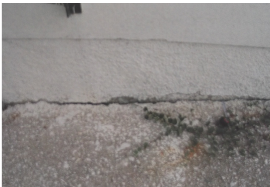
Εικόνα 70:Ρηγμάτωση στην επαφή του κτίσματος με την πλάκα σκυροδέματος
