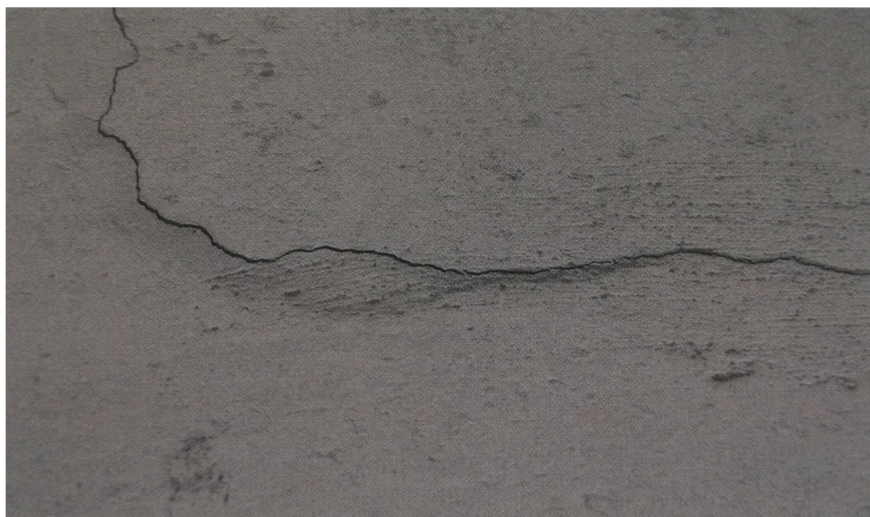
Εικόνα 68:Εμφανής ρηγμάτωση στην Νότια όψη
