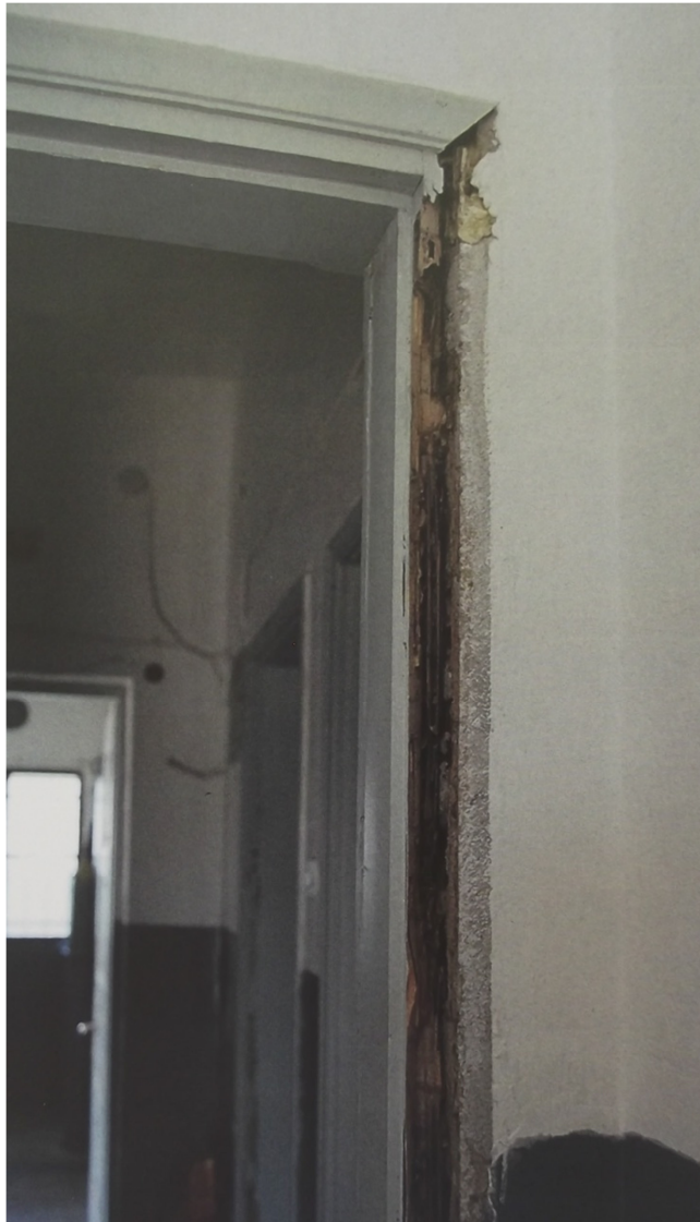
Εικόνα 72:Διάβρωση ξύλινων κουφωμάτων στο εσωτερικό
