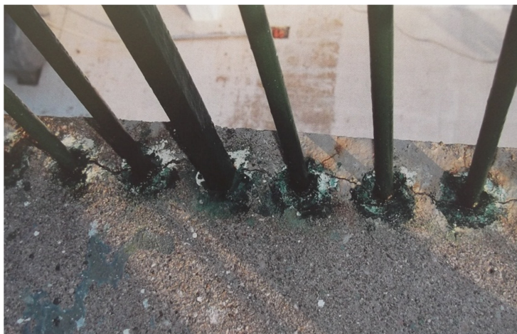
Εικόνα 91: Διάβρωση του μεταλλικού κιγκλιδώματος του εξώστη του φανού και ρηγματώσεις στην πλάκα λόγω διάβρωσης οπλισμού. Πηγή : 'Πέτρινοι φάροι από το χθές στο σήμερα', Εργαστήριο Δομικών υλικών Τμήμα Πολιτικών Μηχανικών ΑΠΘ, Εκδόσεις: Κλειδάριθμος
