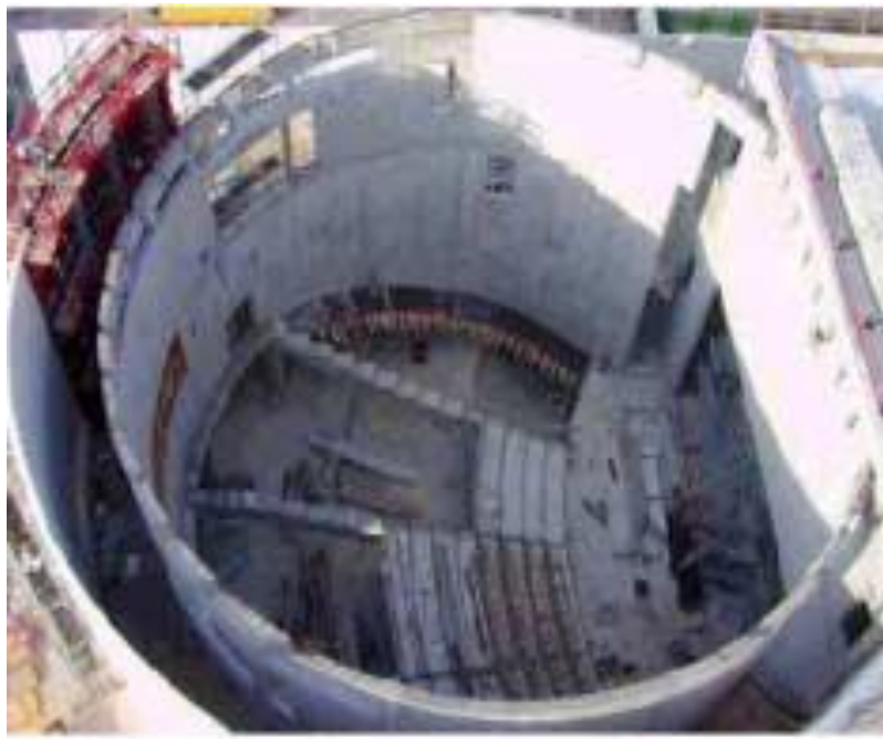
Εικόνα 5.30 Τα δύο ομόκεντρα τοιχεία στο Κέντρο Τέχνης της Meudon κατά την κατασκευή τους [11].
