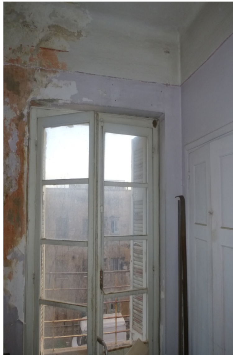
Εικόνα 30: Φθορές στο εσωτερικό
