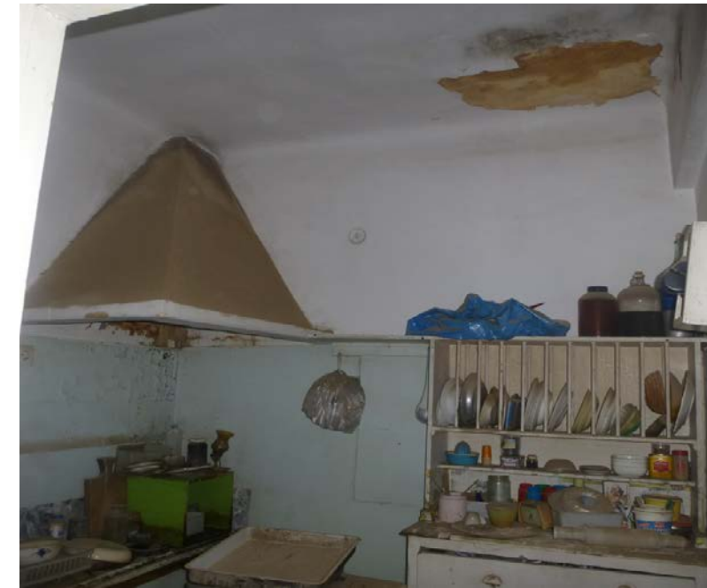
Εικόνα 32: Εμφάνιση υγρασίας στην πλάκα
