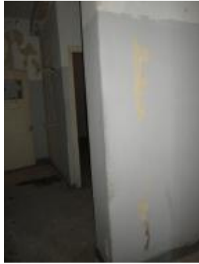
Εικ.61 Ρωγμή λόγο διαφοράς υλικού
