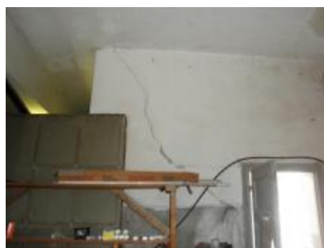
Εικ.58 Διαμπερή ρωγμή
