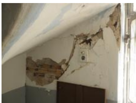
Εικ.57 Ρηγμάτωση στην περιοχή της σκάλας
