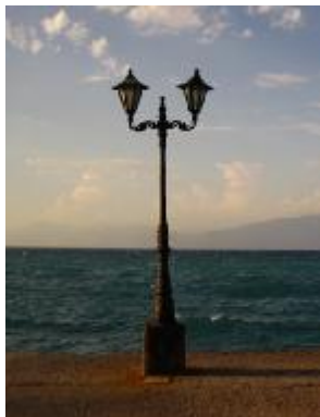
Εικ.42 Οξείδωση φανοστάτη
