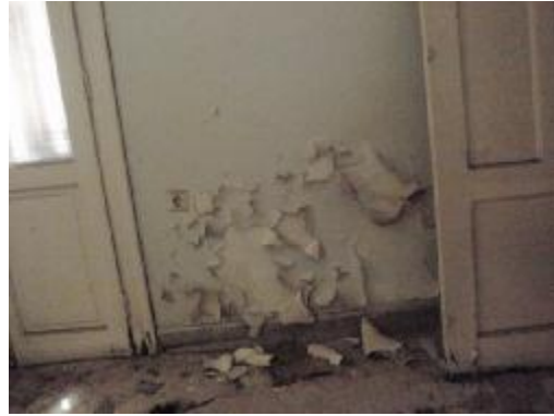
Εικ.62 Αποφλοίωση χρώματος
