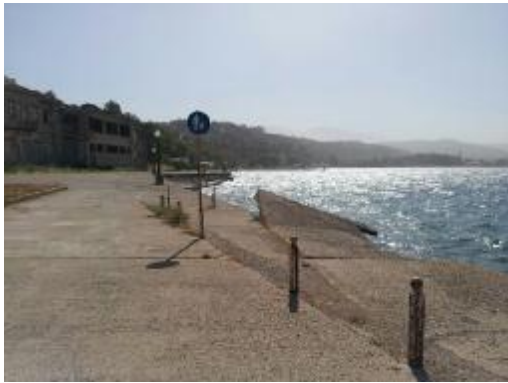
Εικ.40 Κατάρρευση τμήματος του παραλιακού μετώπου
