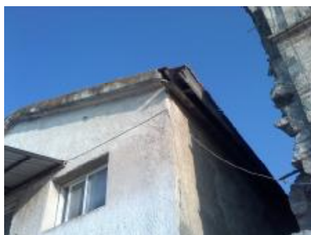
Εικ.50 Διάβρωση τμήματος της στέγης
