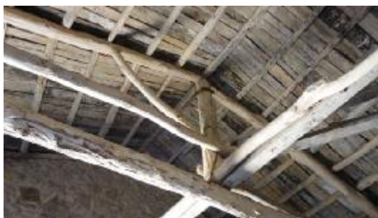
Εικ. 52: Φθορές εσωτερικά της στέγης
