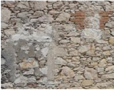
Εικ. 24: Μάρτυρες απομίμησης οπτοπλινθοδομής και τσιμεντοκονιάματος
