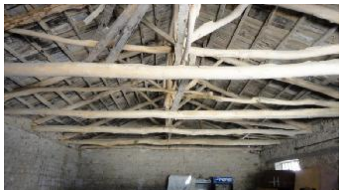
Εικ. 53: Φθορές εσωτερικά της στέγης
