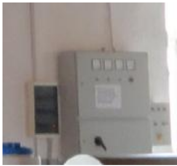
Εικ. 66: Ηλεκτρολογικός Πίνακας
