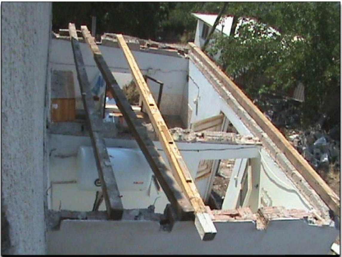
Εικόνα 112 : κουζίνα και μπάνιο χωρίς στέγη ελενίτ
