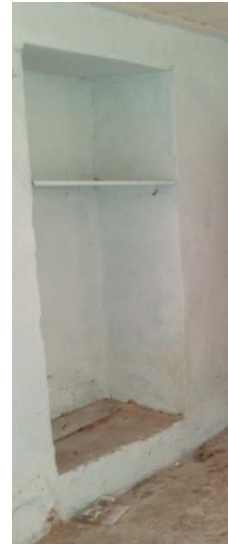
Εικόνα 33: Άνοιγμα στο ισόγειο.
