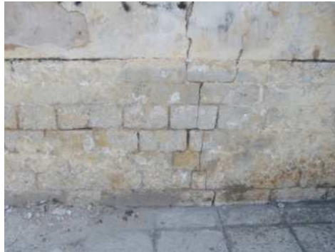
Εικόνα 64: Ρωγμή στη βάση του κτιρίου
