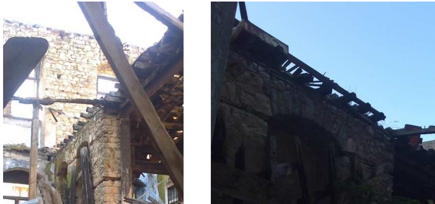
Εικόνα 37-38 : Τμήματα που έχουν απομείνει από το δάπεδο ορόφου
