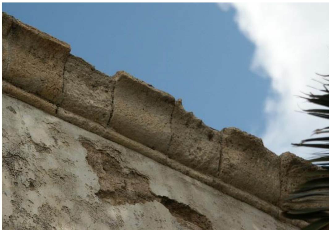
Εικόνα 21 Στην μαρμάρινη επίστεψη του στηθαίου στο δώμα δεν παρατηρούνται σοβαρές βλάβες εκτός από την απώλεια μίας πλάκας στο νότιο τμήμα.
