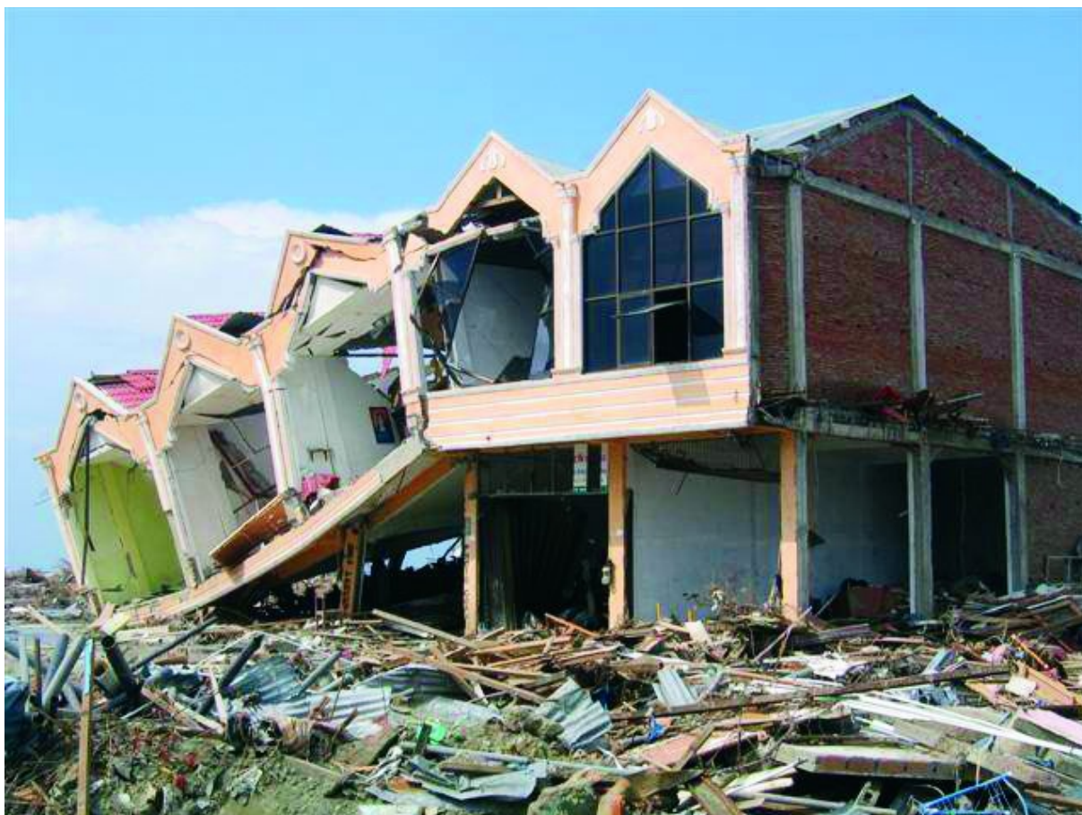
Φωτογραφία 9: Καταστροφή σε κτίριο από μπετό
