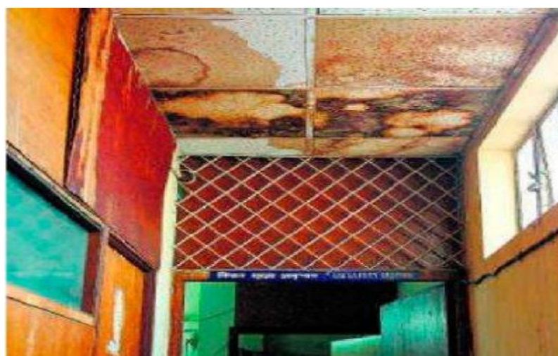
Εικόνα 3. 25 & Εικόνα 3. 26: Παραδείγματα κατασκευών που πάσχουν από το <<σύνδρομο του άρρωστου κτιρίου>>.
