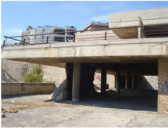
Εικόνα 25: Στάθμη Δ - Η εναλλαγή κινησιωμάτων και στηθαίων.
