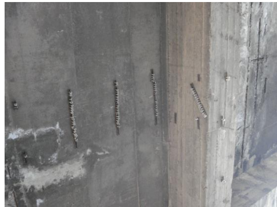
Εικόνα 28: Στάθμη Δ - Τα στηρίγματα σωληνώσεων και καλωδίων.
