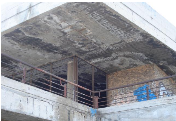
Εικόνα 33: Η επίδραση της υγρασίας στην πλάκα και η οξείδωση των κιγκλιδωμάτων και μεταλλικών πλαισίων που θα υποβάσταζαν τα υαλοστάσια.
