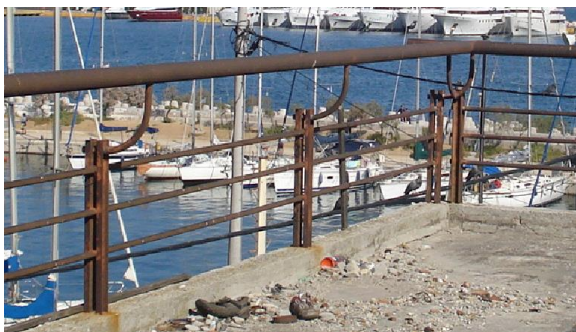
Εικόνα 34: Σημεία με εμφανή οξείδωση κιγκλιδωμάτων.
