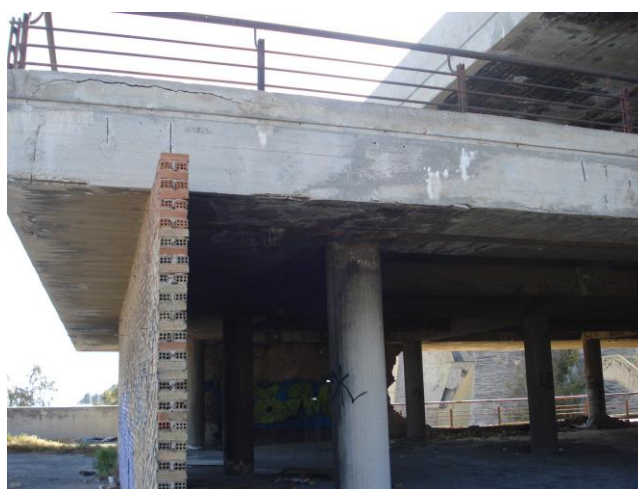
Εικόνα 30: Ρηγματώσεις στη πλάκα αλλά και στο στηθαίο με τα εγκιβωτισμένα κιγκλιδώματα.
