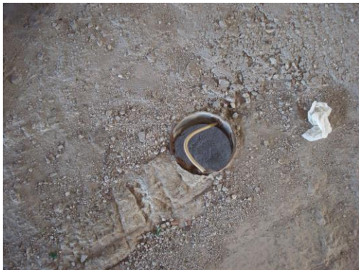
Εικόνα 27: Στάθμη Β - Οπές και αναμονές καλωδίων.
