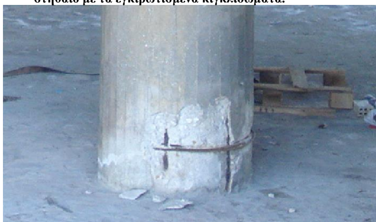
Εικόνα 32: Σε πολλά σημεία των υποστυλωμάτων, αποκόλληση σκυροδέματος και διάβρωση οπλισμού.
