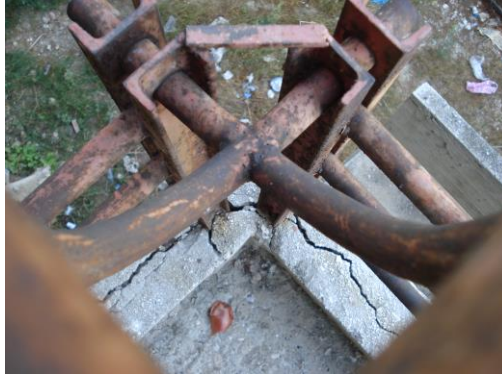
Εικόνα 36: Ρηγματώσεις εγκιβωτισμένων μεταλλικών κυκλιδωμάτων.
