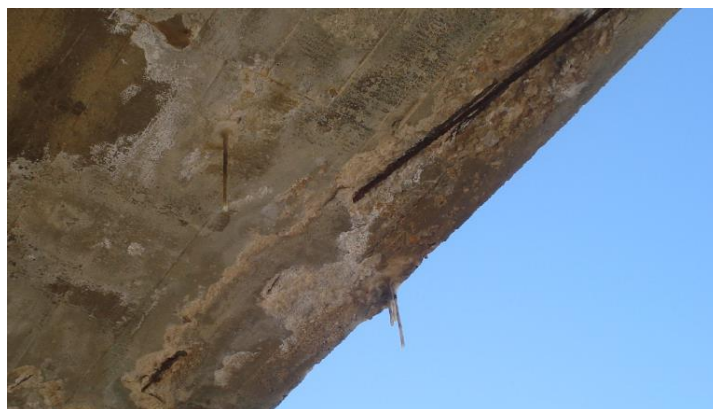
Εικόνα 31: Αποκόλληση σκυροδέματος με εμφάνιση σιδηροπλισμού και δημιουργία σταλαγμιτών.
