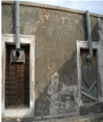
30. αποκόλληση επιχρισμάτων αποκάλυψη τοιχοποιίας(Ανατ.Οψη)
