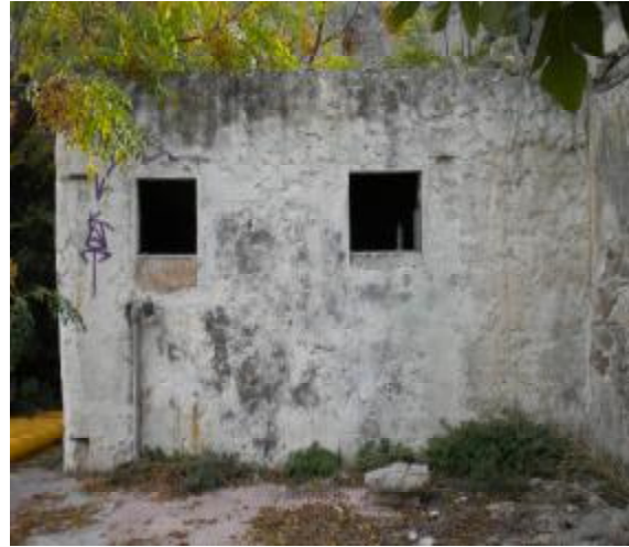
49.Κτίριο 3(εκτεταμένες βλάβες)
