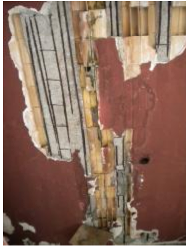
51.Κ2 εμφάνιση και οξείδωση οπλισμού
