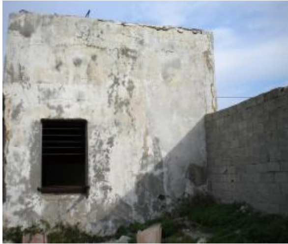
48.Κτίριο 2(εκτεταμένες βλάβες)
