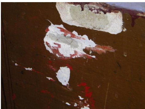
Εικόνα 070 Κτήριο Α φθορές τοιχοποιίας
