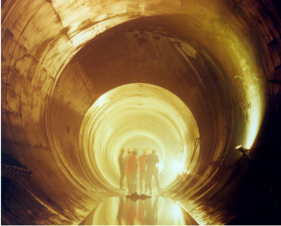
Γαλαρία νερού υπό πίεση
