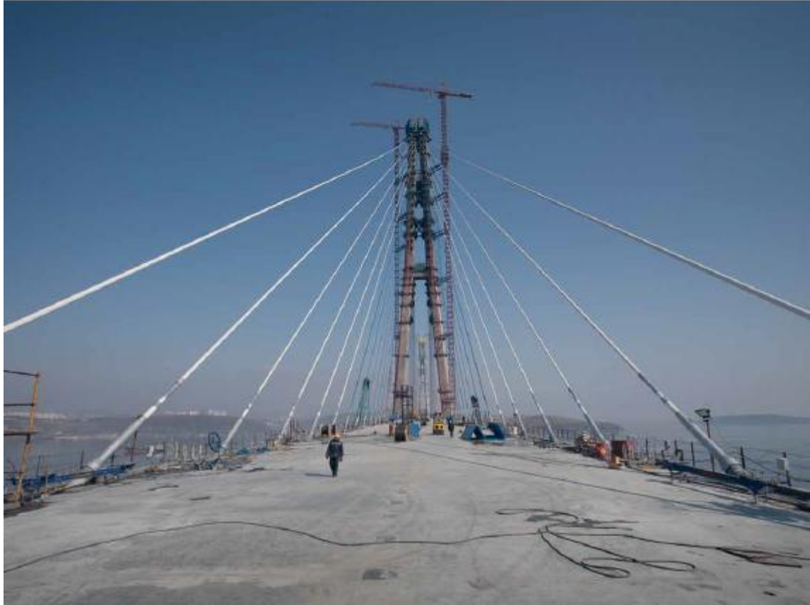
Άποψη των καλωδίων
