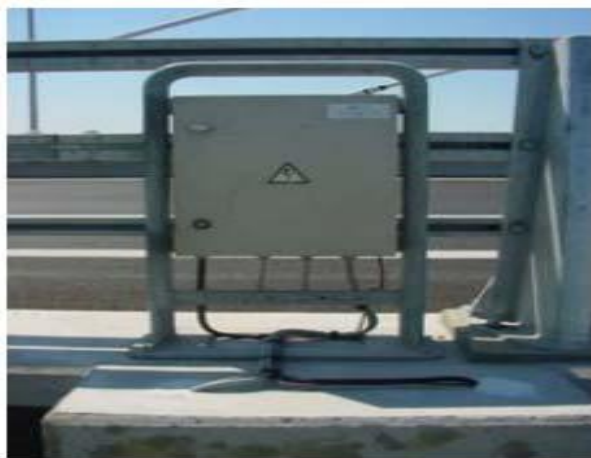
Σχήμα 4.3.4 : Ηλεκτρολογικός πίνακας [Π. Πανακίκλας κ.α., 2009]
