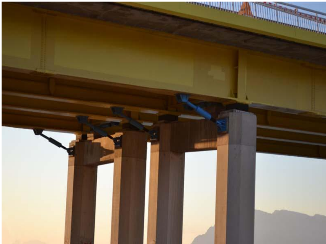
Φωτ. 5.7 : Αποσβεστήρες (dampers) της γέφυρας (σε βάθρο της γέφυρας πρόσβασης).
