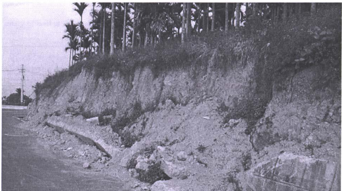
Σχήμα 4.5 Αστοχία τοίχου βαρύτητας λόγω υπέρβασης φέρουσας ικανότητας και ανατροπής κατά το σεισμό Chi-Chi της Ταϊβάν (1999) (Fang et al. 2003)
