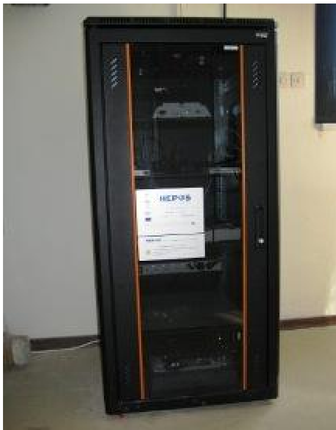
Εικόνα 3.6: Rack Σταθμού Αναφοράς
