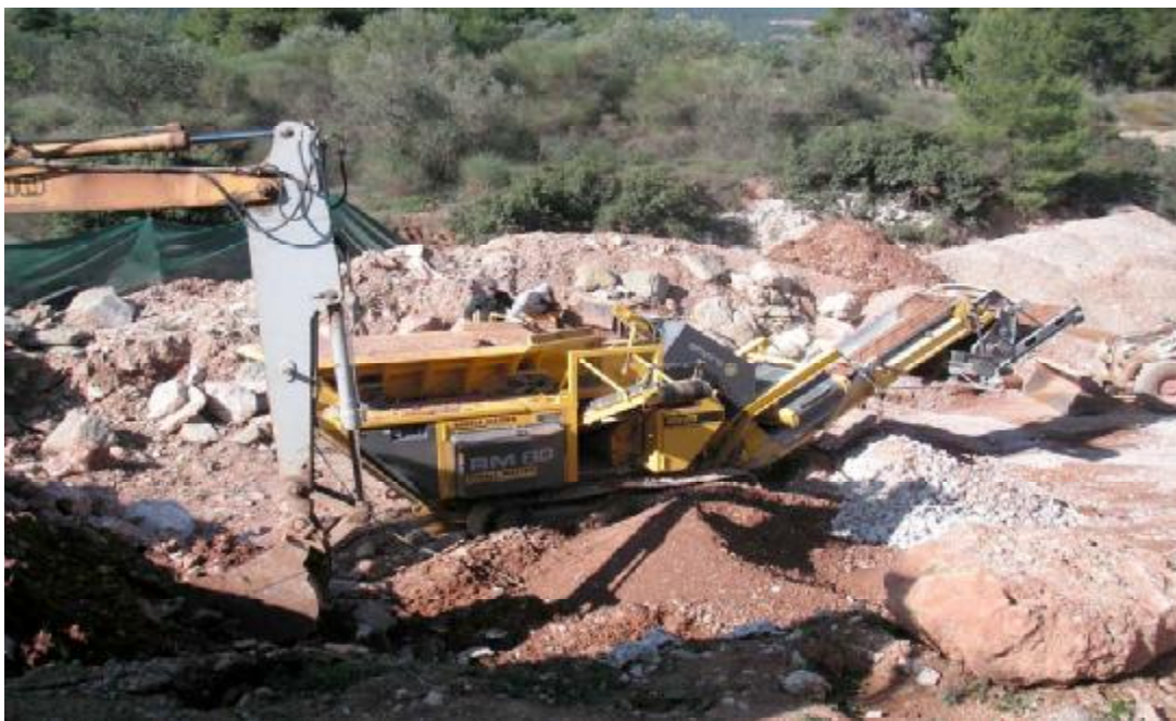
Πρόβλημα στο ρότορα 2 (overload)
