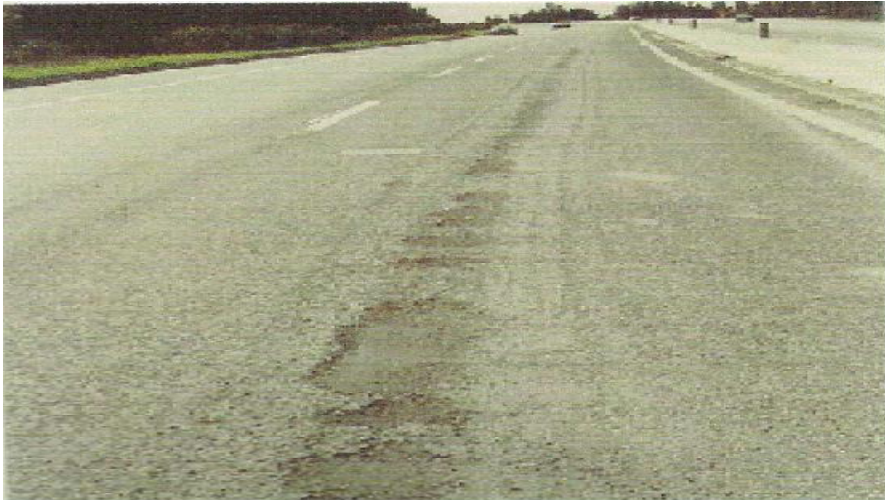
Εικ.5: Αποσύνθεση επιφάνειας οδοστρώματος
