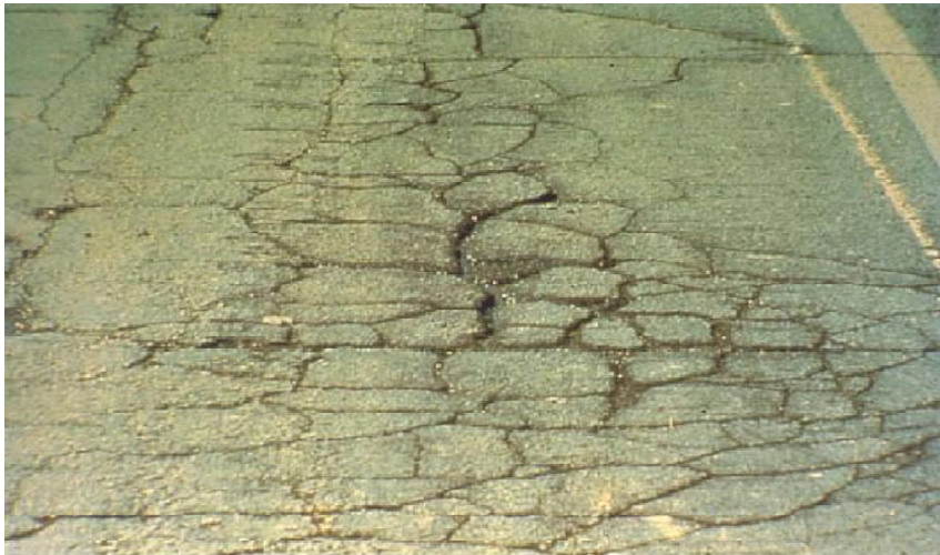
Εικ:3 Ρωγμές μορφής αλιγάτορα
