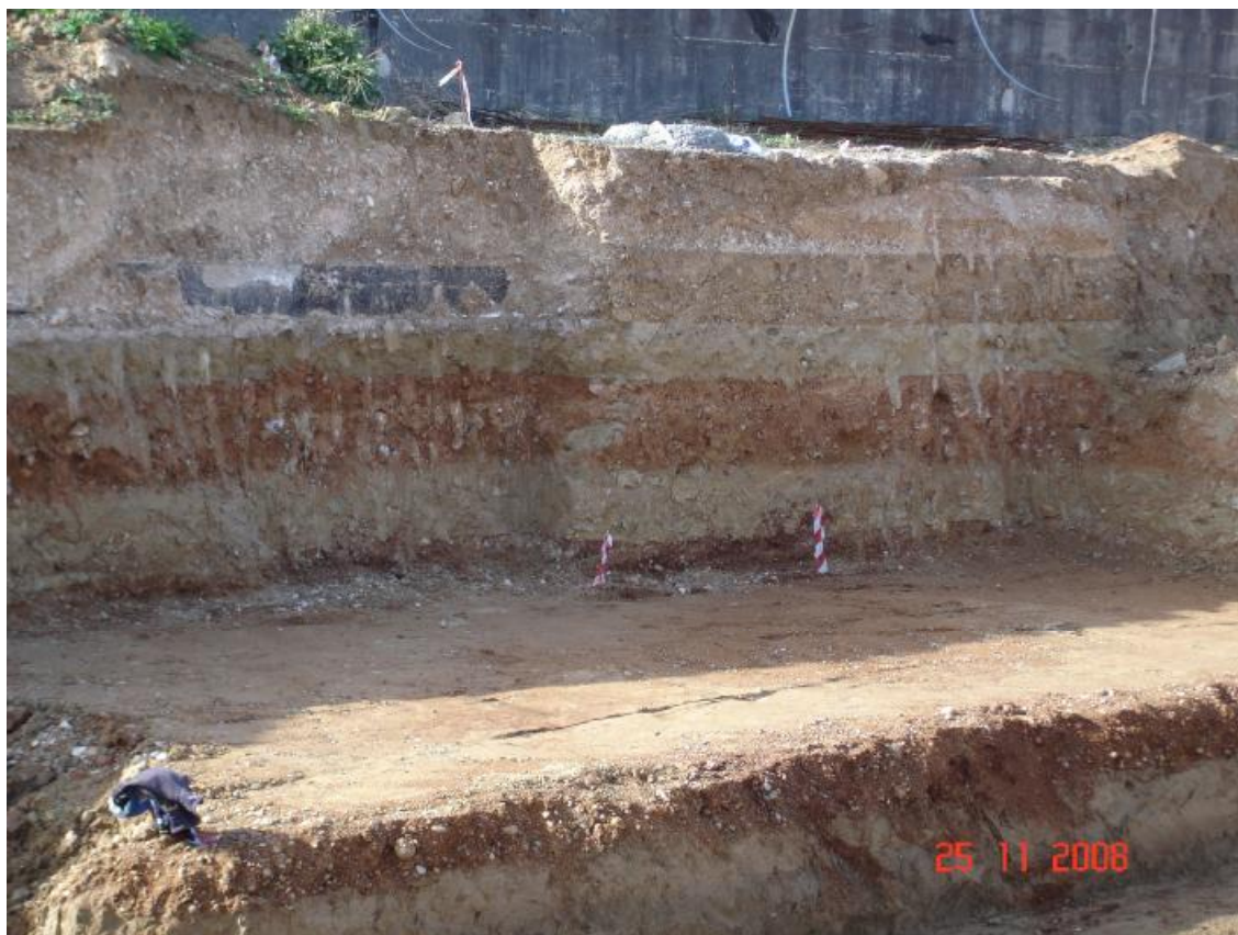
Εικόνα 18 φωτο από την κατασκευή του έργου που φαίνεται ζωντανά το γεωτεχνικό προφίλ
