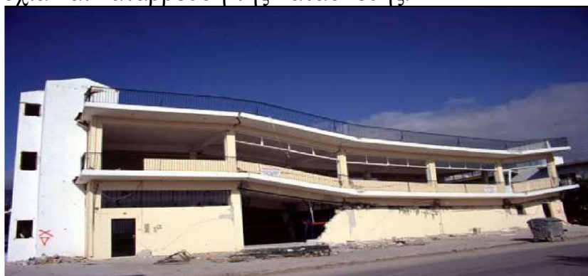
Αστοχία σειράς κοντών υποστυλωμάτων
