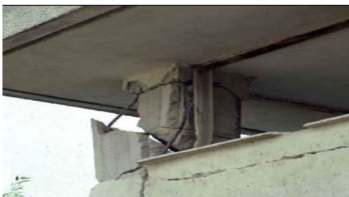
Αστοχία κοντού υποστυλώματος
