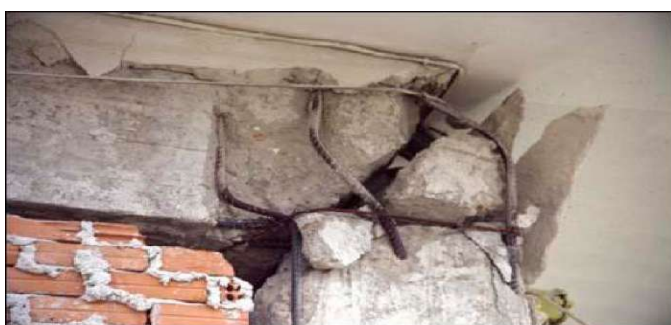
Αστοχία εξωτερικού κόμβου και πρακτική απώλεια στήριξης δοκού
