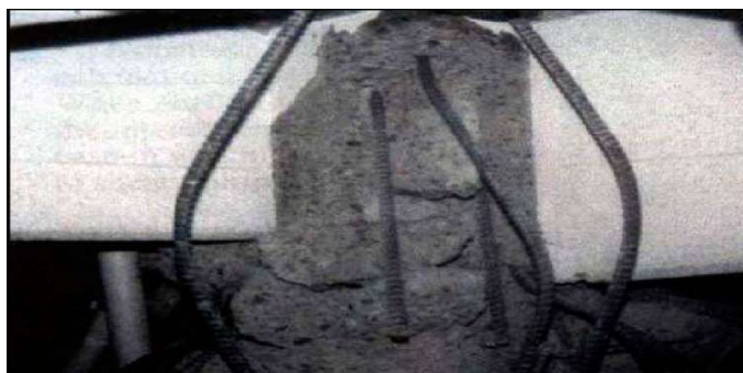
Διάρρηξη απερίσφιγκτου σκυροδέματος κόμβου (Fib Bulletin 24)
