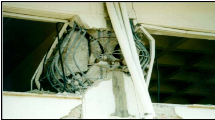
Αστοχία κολώνας 5όρου οικοδομής στην περιοχή των Άνω Λιοσίων (έκτακτη κατασκευής 1997) η οποία προκλήθηκε από το σεισμό της 7ης Σεπτεμβρίου 1999 (M=5.9) (Anastasiadis et al., 1999).
