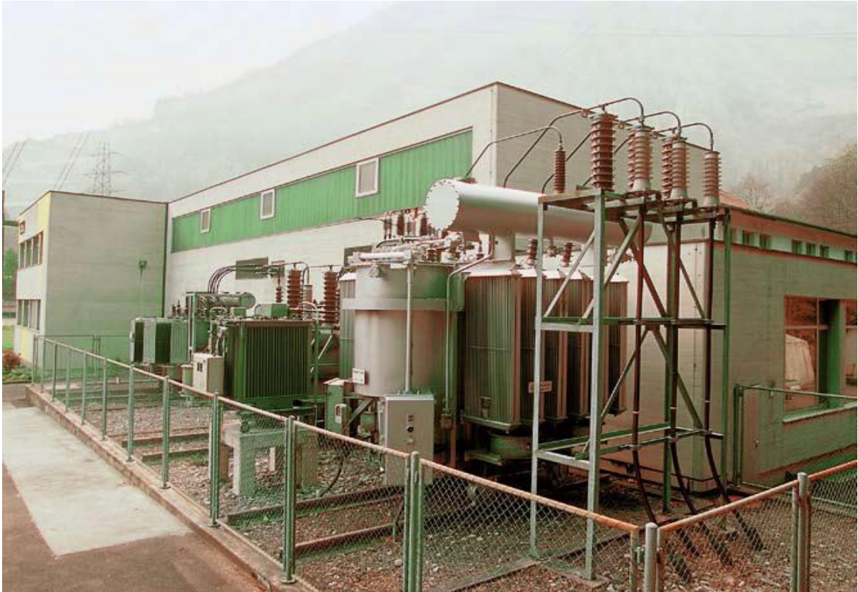
Σταθμός ηλεκτρικής ενέργειας στο Amsteg
