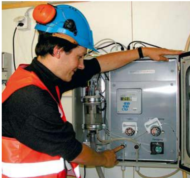
Μονάδα ελέγχου του νερού
