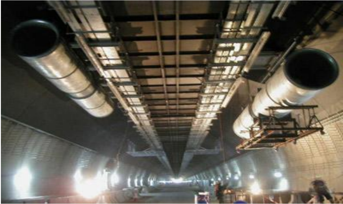
Σύστημα εξαερισμού στο Gotthard
