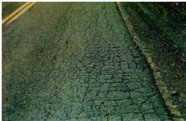
Φ.1 «Ρωγμή τύπου αλιγάτορα»
