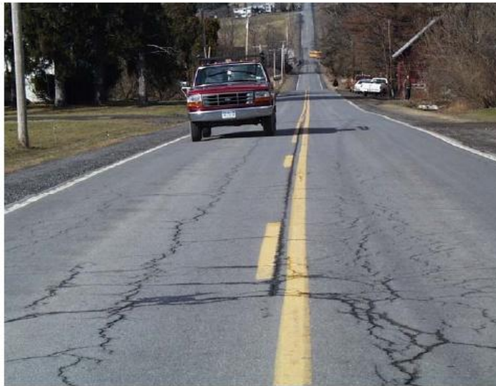
Φ.7 «Ρωγμές στην τροχιά των τροχών»
