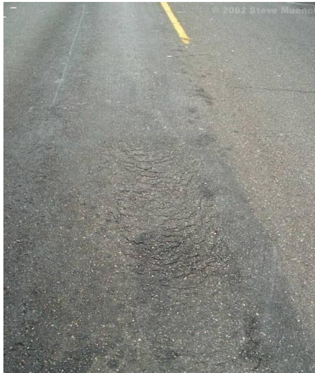
Φ.5 «Ρωγμές από ολίσθηση ταπήτων»
