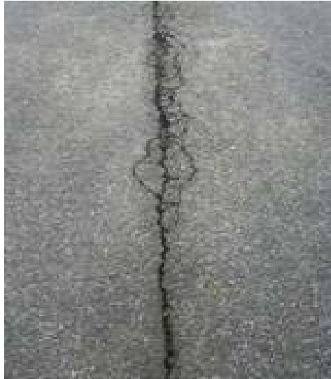
Φ.3 «Ρωγμές μεταξύ λωρίδων»
