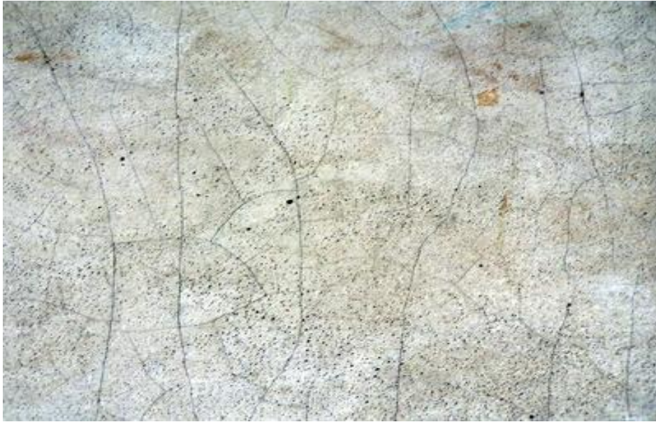
Φ.2 «Ρωγμές στα άκρα του οδοστρώματος»
