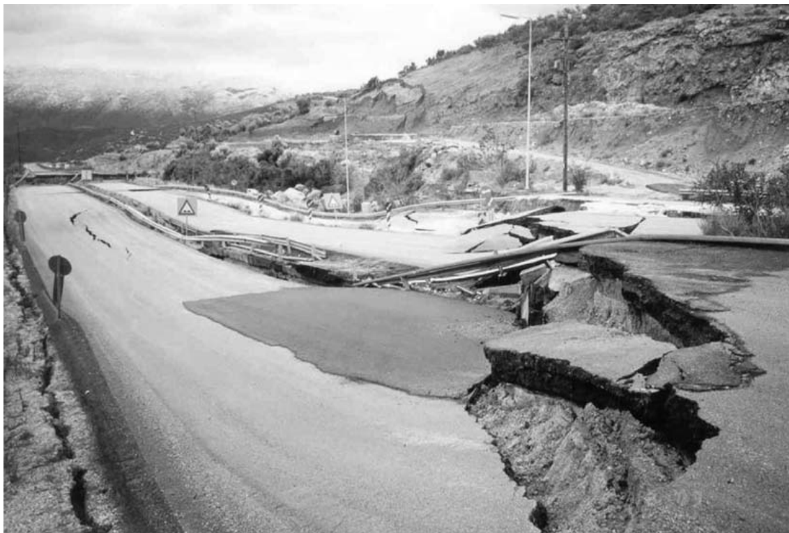
Σχήμα 5. Άποψη του βυθίσματος που προκάλεσε η κατολίσθηση στο οδόστρωμα της Ε.Ο. Κορίνθου-Τρίπολης.
