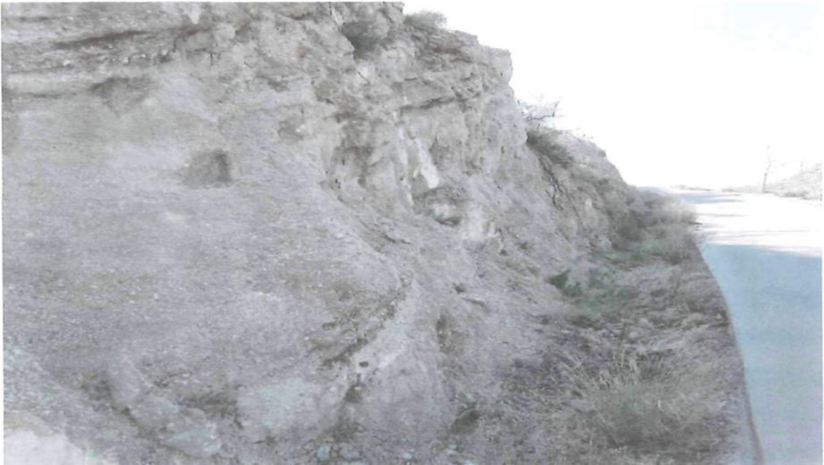
ΦΩΤΟΓΡΑΦΙΑ 8 : Χ. Θ 5+100 3ου Τμήματος Κολλουβιακοί σχηματισμοί
