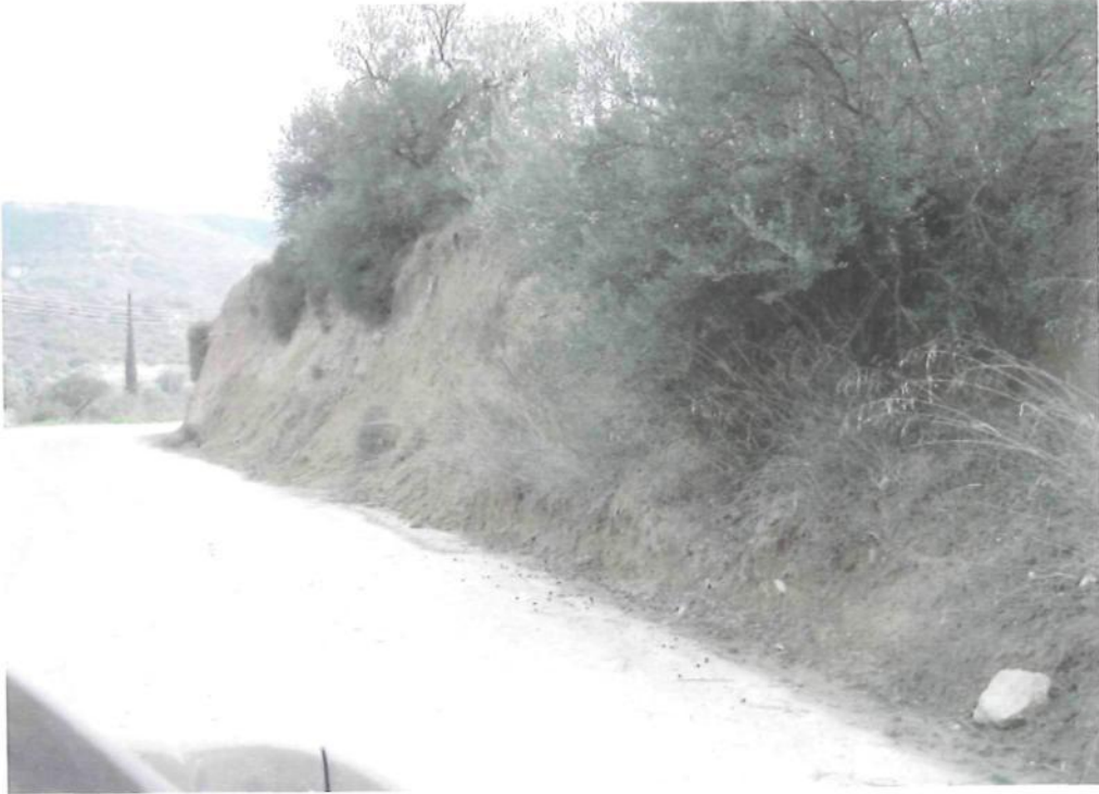
ΦΩΤΟΓΡΑΦΙΑ 1 : Χ.Θ 7+400 Ιου Τμήματος Ο οδικός άξονας εδράζεται επι των μαργών του πλειόκαινου
