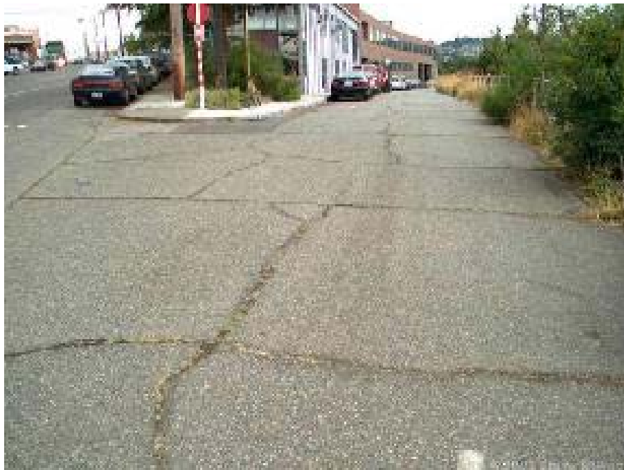
Εικόνα 20. Ρωγμές από ανάκλαση
