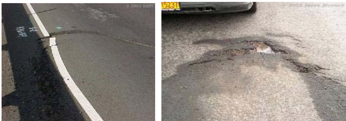
Εικόνα 21. Ρωγμές από ολίσθηση ταπήτων
