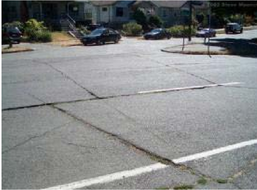
Εικόνα 19. Ρωγμές από ανάκλαση
