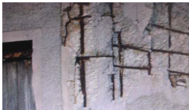
3.3.4 Εκτίναξη επικάλυψης οπλισμού σε τοιχοποιία
