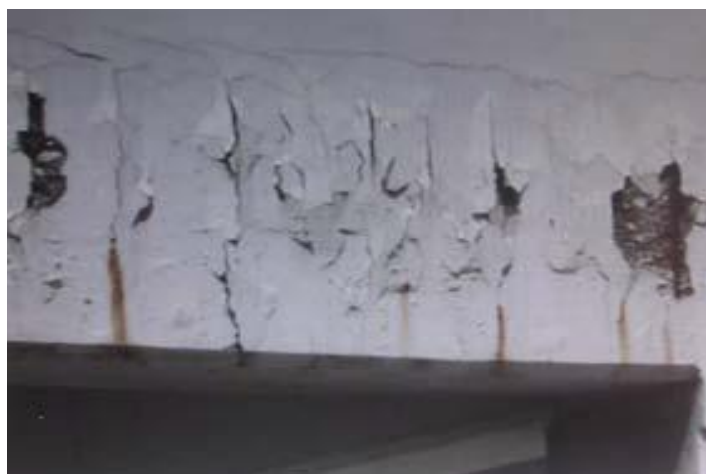
3.3.2 Αποφλοίωση σκυροδέματος σε τοιχοποιία
