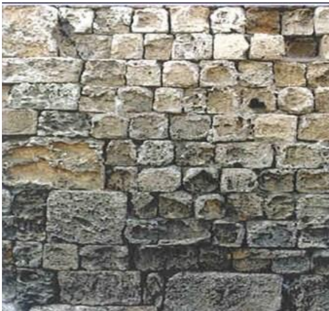
4.3.3 Αποκόλληση τμήματος τοιχοποιίας στη μεσαιωνική πόλη της Ρόδου
