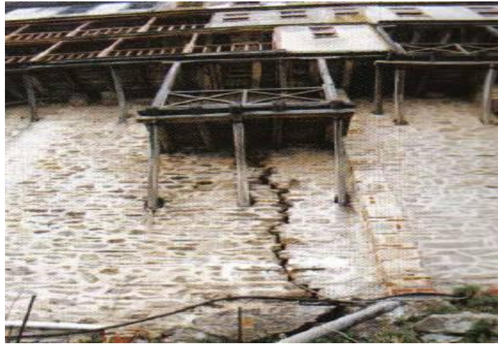
2.3.2 Κατακόρυφες διαχωριστικές ρωγμές σε εξωτερικό τείχος
