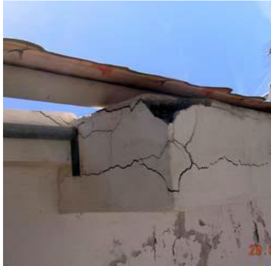
3.3.1 Ρηγμάτωση σε τοιχοποιία παράλληλα στον οπλισμό
