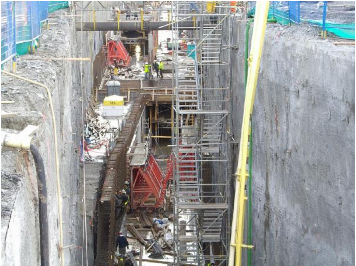
Σχήμα 4.1: Αρχικό στάδιο της μεθόδου ανοικτού ορύγματος όπου έχει γίνει η εκσκαφή και πρόκειται να ξεκινήσει η κατασκευή της σήραγγας.
