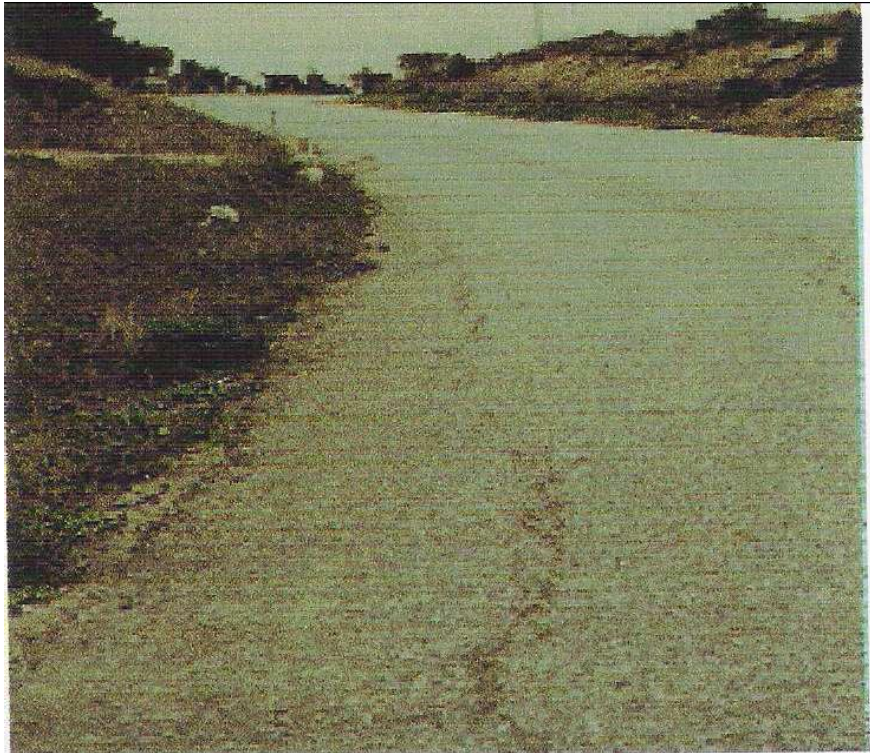
‘Ρωγμές στα άκρα του οδοστρώματος’
