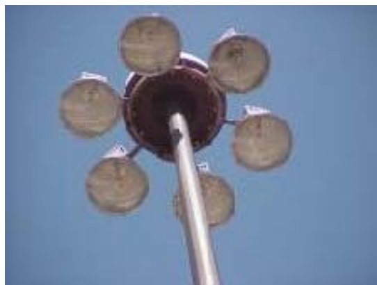
Εικόνα 1.4: Φωτιστικά σώματα υψηλού ιστού.
