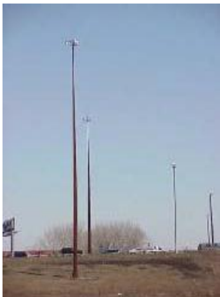
Εικόνα 1.9: Φωτισμός επί υψηλών ιστών.
