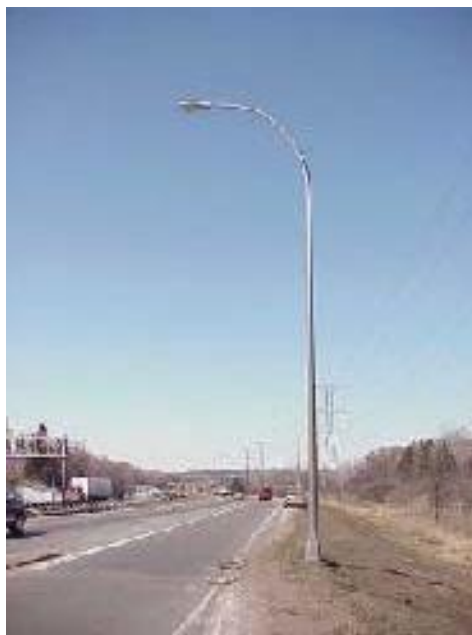
Εικόνα 1.6: Στύλος φωτισμού με καμπύλο βραχίονα.
