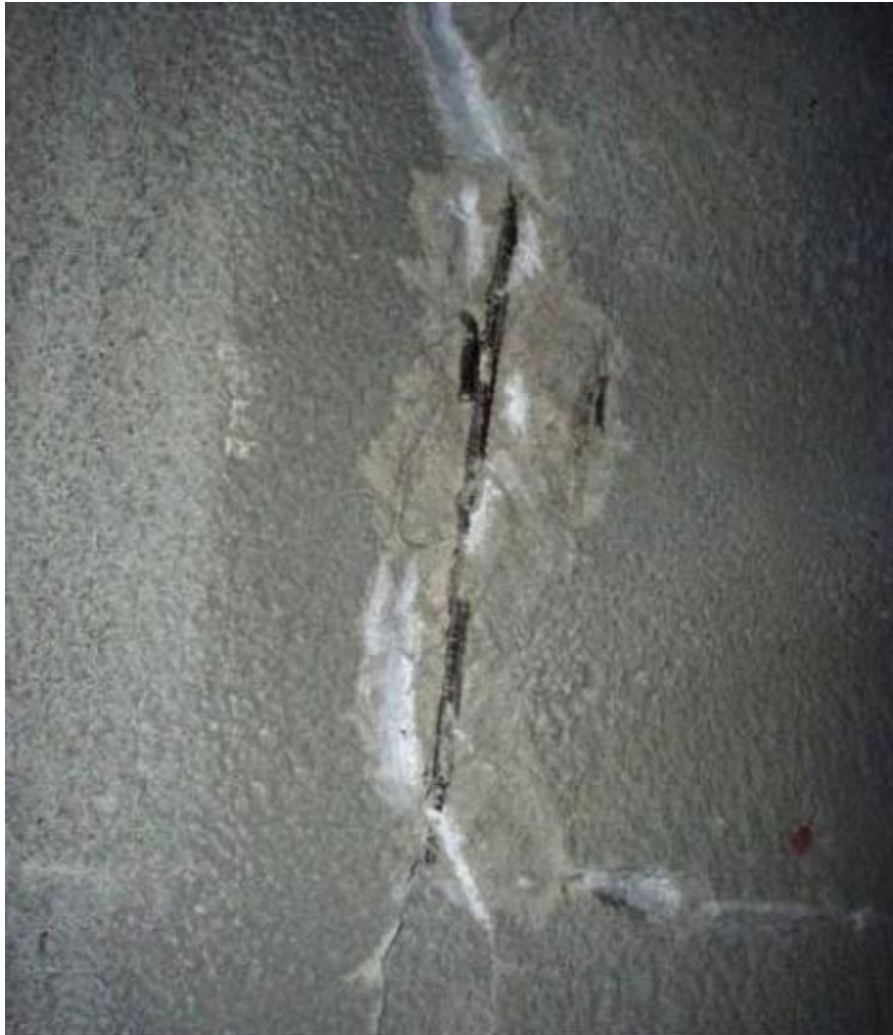
Σχήμα 11 Ρηγμάτωση εκτοξευόμενου σκυροδέματος γύρω από δικτυωτό πλαίσιο
