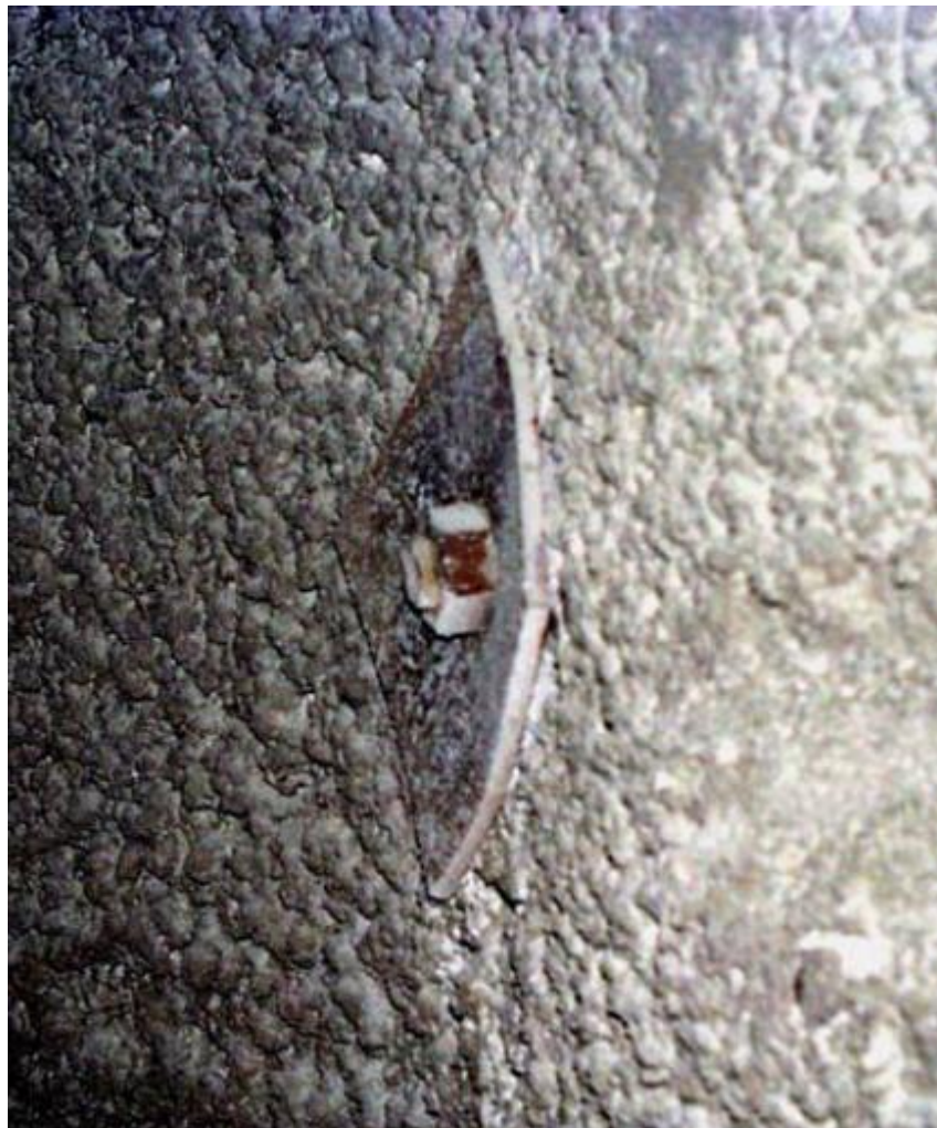
Σχήμα 12 Παραμορφωμένη πλάκα αγκυρίου (face plate) λόγω αστοχίας υποστήριξης
