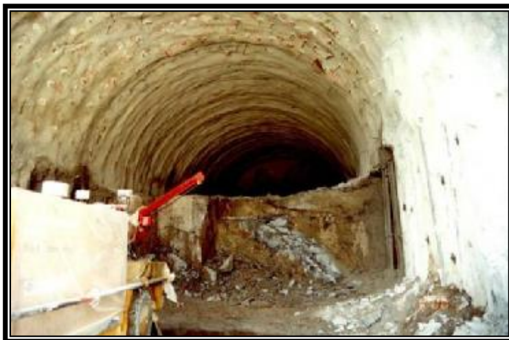
Μέτωπο Εξόδου : Τσιμεντενέσεις – Εκσκαφή Α΄ Φάσης – Εκσκαφή Β΄ Φάσης και invert στα πρώτα μέτρα
