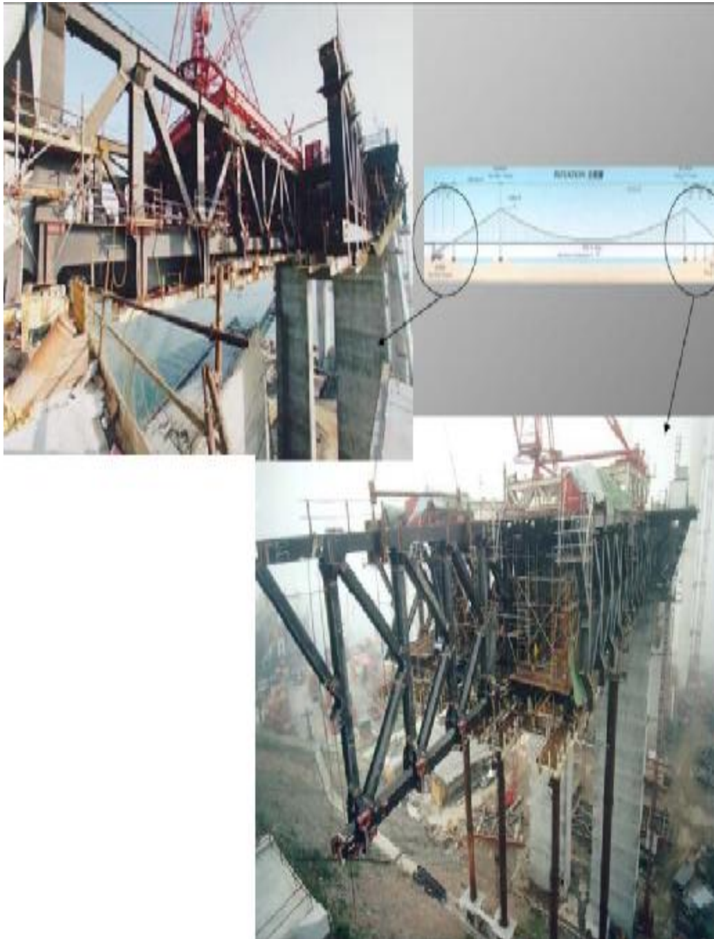
Ανέγερση των ανοιγμάτων σε Tsing Yi και Ma Wan με την εγκατάσταση των προκατασκευασμένων στοιχείων
