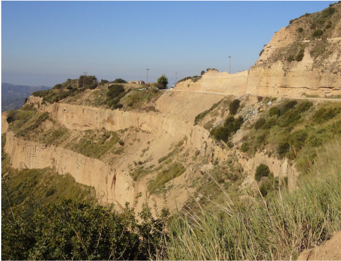
Εικ. 10: Σημείο του κατάντι πρανούς, στο οποίο είναι απαραίτητη η τοποθέτηση συρματοκιβωτίων
