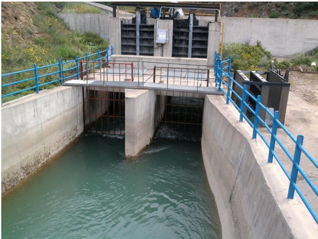
Εικόνα 3.7 Ρυθμιστής ροής τύπου Λ στο υδραγωγείο του Μόρνου.
