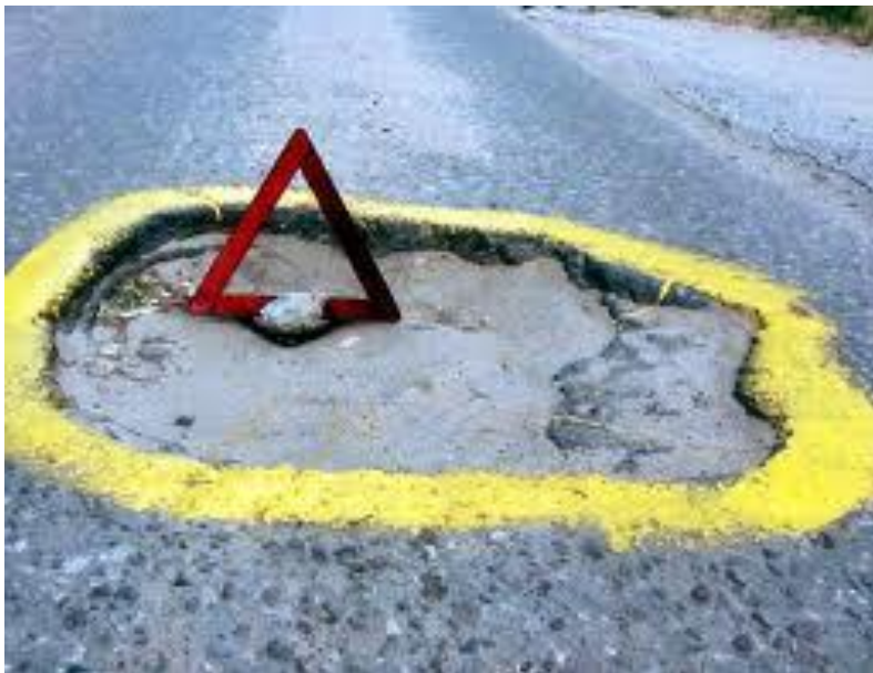
Εικόνα 4.6: Λακκούβα πριν την αποκατάσταση της
