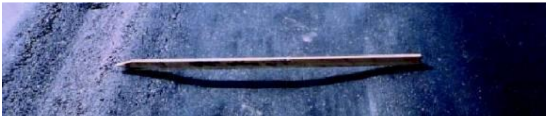
Εικόνα 2.1: Κατά μήκος αυλάκωση οδοστρώματος
