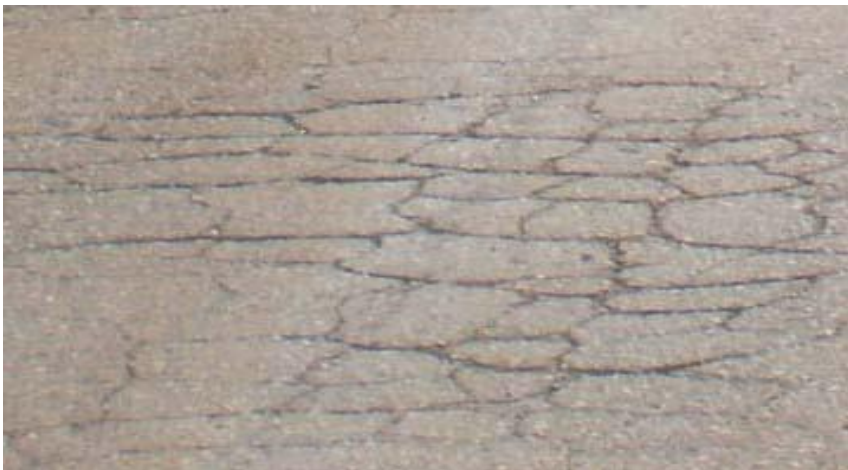
Εικόνα 2.6: Ρωγμές από ολίσθηση
