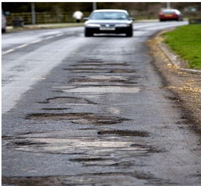
Εικόνα 2.7: Χαρακτηριστικές λακκούβες σε οδόστρωμα
