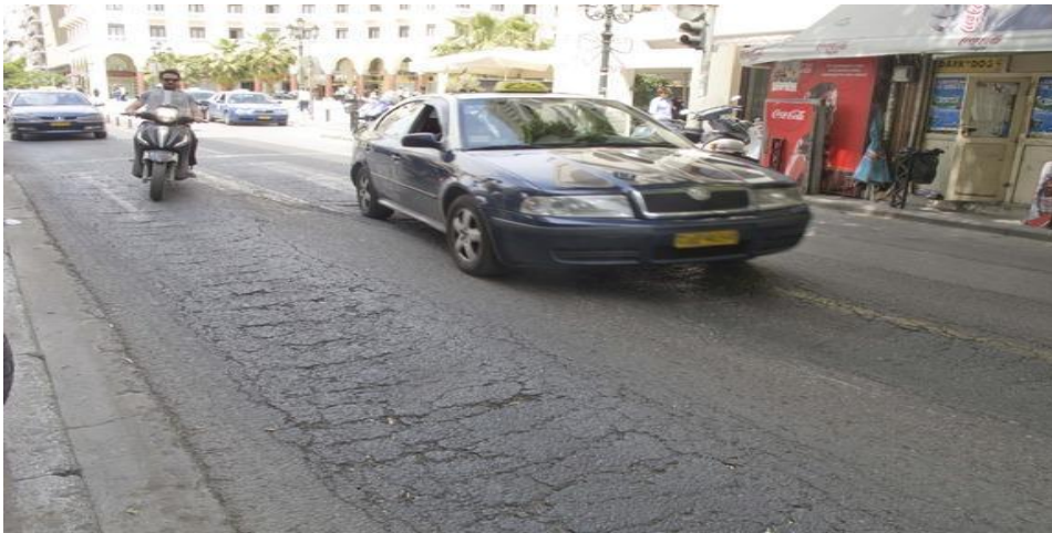
Εικόνα 2.5: Ρωγμές στα άκρα του οδοστρώματος
