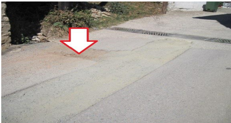
Εικόνα 2.2: Κατά πλάτος αυλάκωση οδοστρώματος
