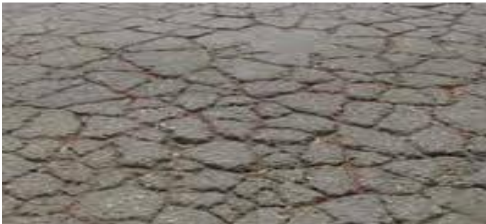
Εικόνα 2.4: Ρωγμές οδοστρώματος μορφής αλλιγάτορα
