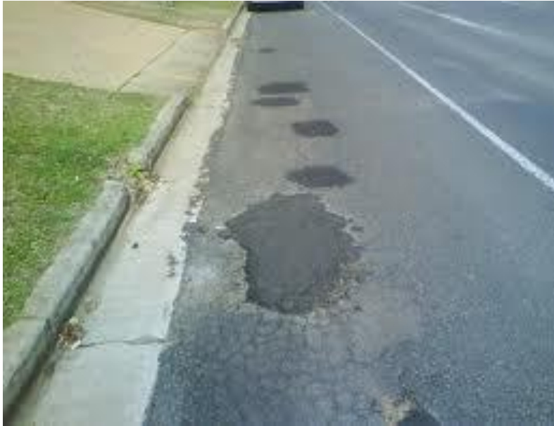
Εικόνα 4.7: Κατεστραμμένο κομμάτι τύπου αλιγάτορα
