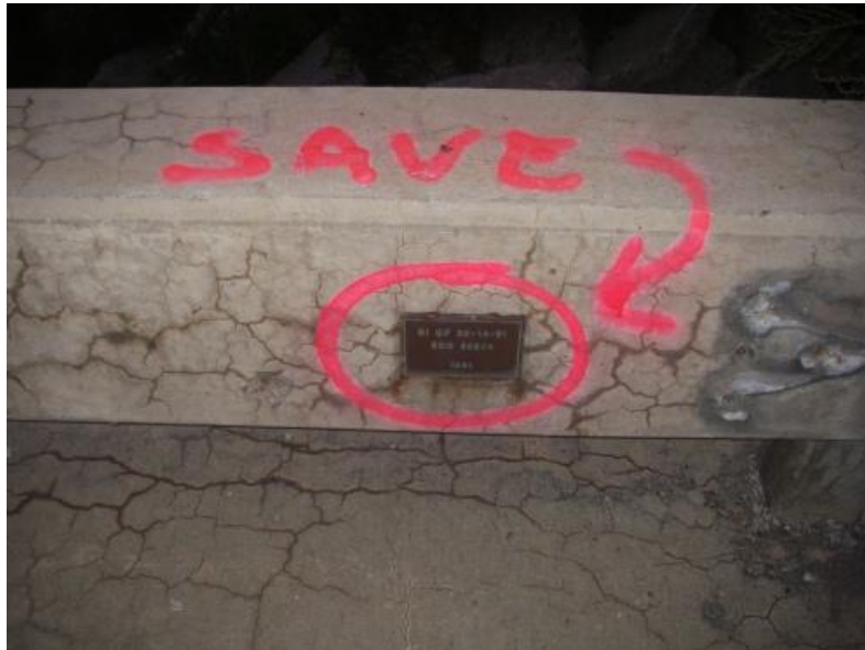
Οι επιδράσεις σε σκυρόδεμα που προκύπτει από τη διείσδυση χλωρίου
