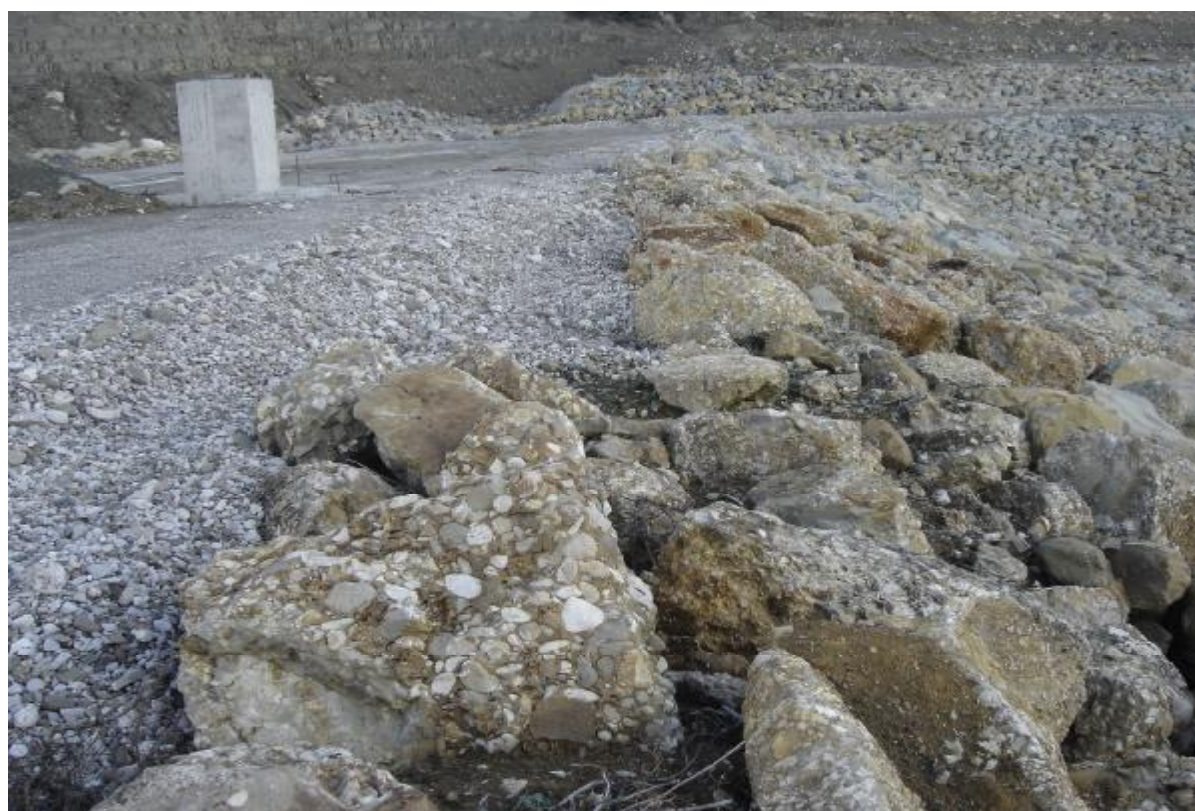
Εικόνα 2: Βάθρο ελέγχου επιφανειακών παραμορφώσεων φράγματος
