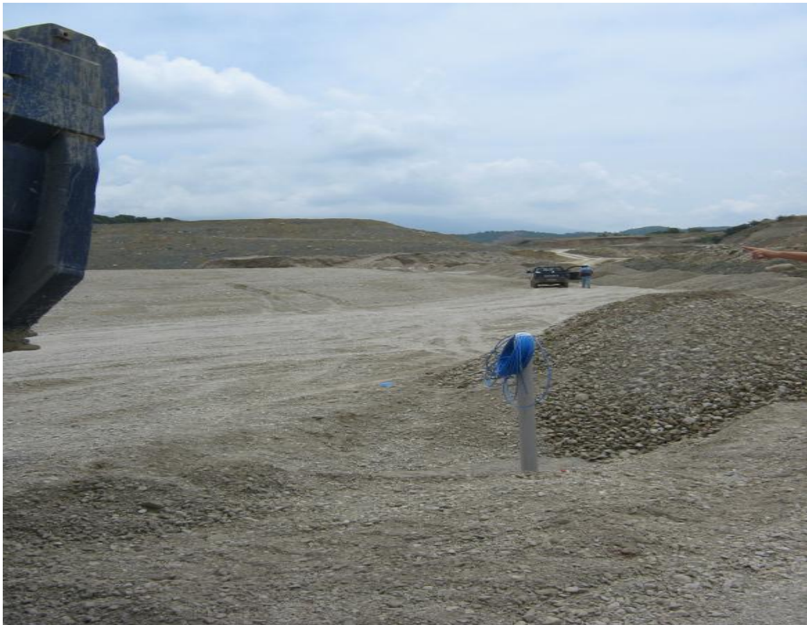
Εικόνα 14: Πιεζόμετρα σε Γεώτρηση
