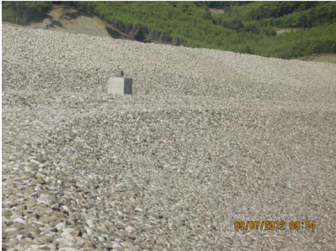
Εικόνα 5: Βάθρο ελέγχου επιφανειακών παραμορφώσεων φράγματος
