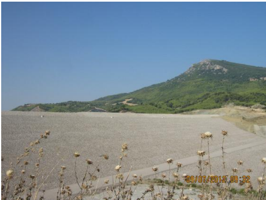
Εικόνα 4: Βάθρα ελέγχου επιφανειακών παραμορφώσεων φράγματος
