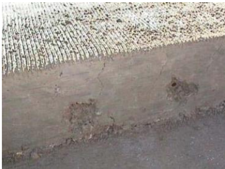
Εικόνα 31 : Ρηγμάτωση λόγω πλαστικής συστολής
