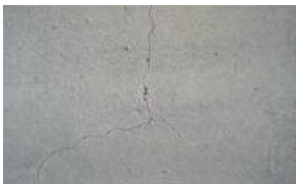
Εικόνες 26-27 Ρηγμάτωση σκυροδέματος σε πλαστική κατάσταση
